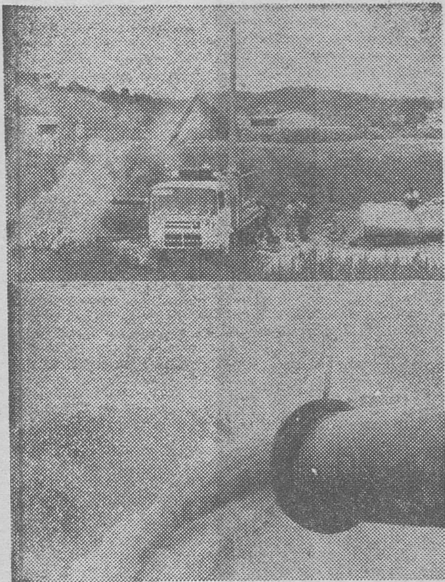
San Cugat del Vallés. — Dos aspectos de uno de los pozos del yacimiento geotérmico descubierto en el término municipal de San Cugat del Vallés, que afloran siete millones de litros de agua por día, a una temperatura de 56 grados (unas 200.000 kilocalorías). Este yacimiento puede aprovecharse para calefacción doméstica, calor industrial, invernaderos e incluso producir energía eléctrica. (Telefoto CIFRA GRAFICA)
