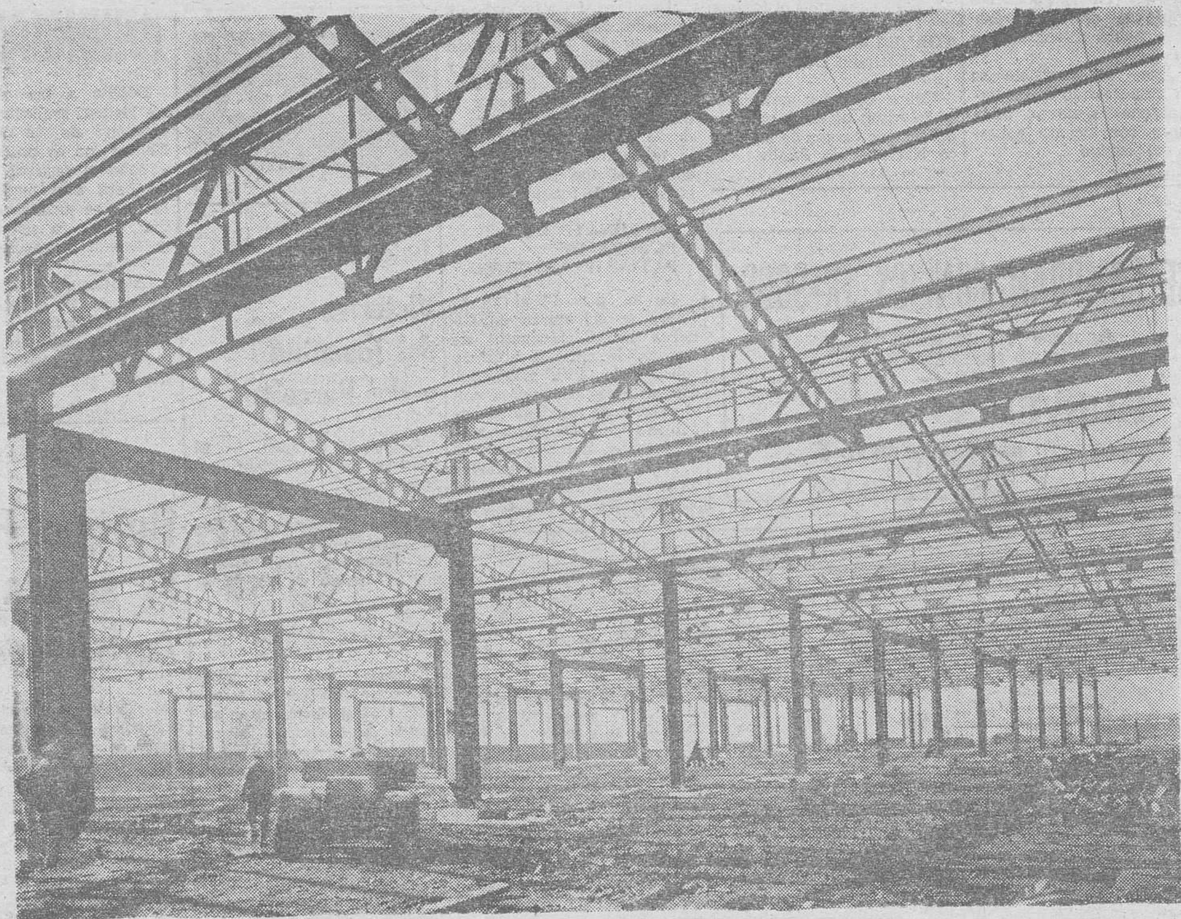
Vista parcial de la ampliación de la factoría FIRESTONE HISPANIA, S. A., en Burgos
