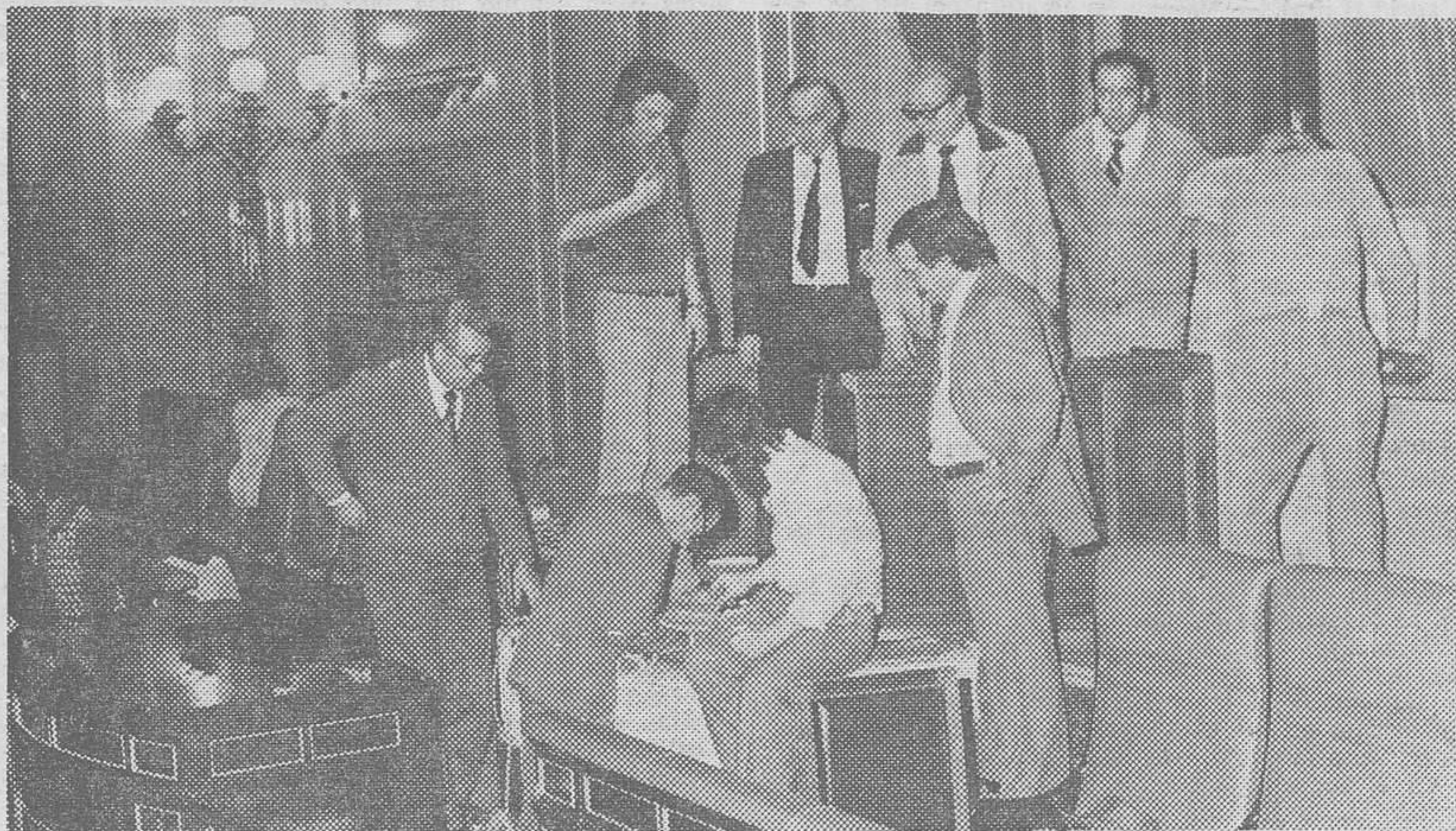
Madrid. — En el palacio de las Cortes Españolas se llevan a cabo diversas obras para adecuar el salón de sesiones para el solemne acto de la proclamación y jura del Príncipe de España como Rey. — (Foto CIFRA GRAFICA).
