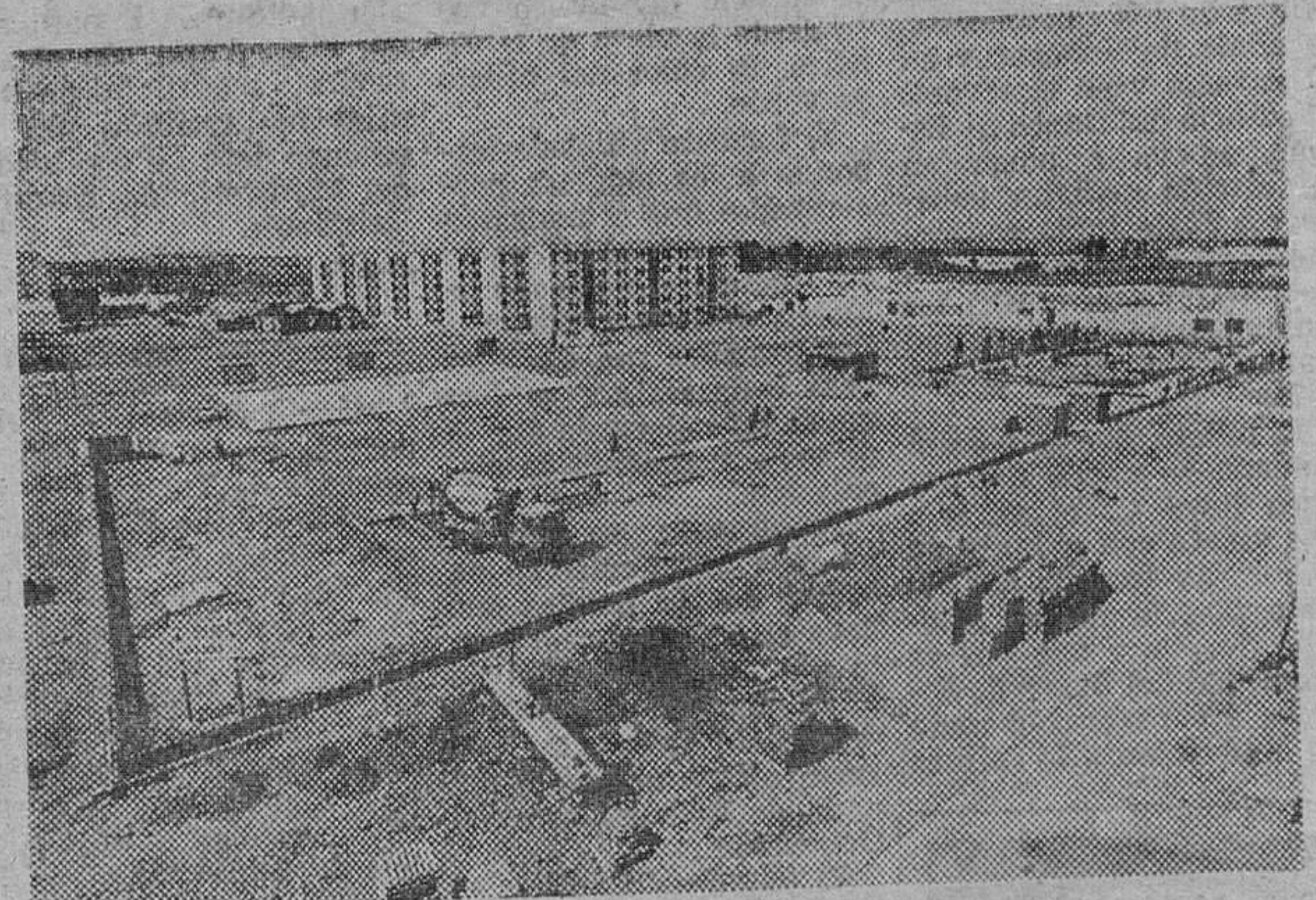
Aspecto de las obras del parque y polideportivo municipal de Santa Catalina, en donde se aprecia ya la construcción de una pista, foto tomada a los ocho días de dar comienzo las obras, lo que indica el ritmo que se lleva.
