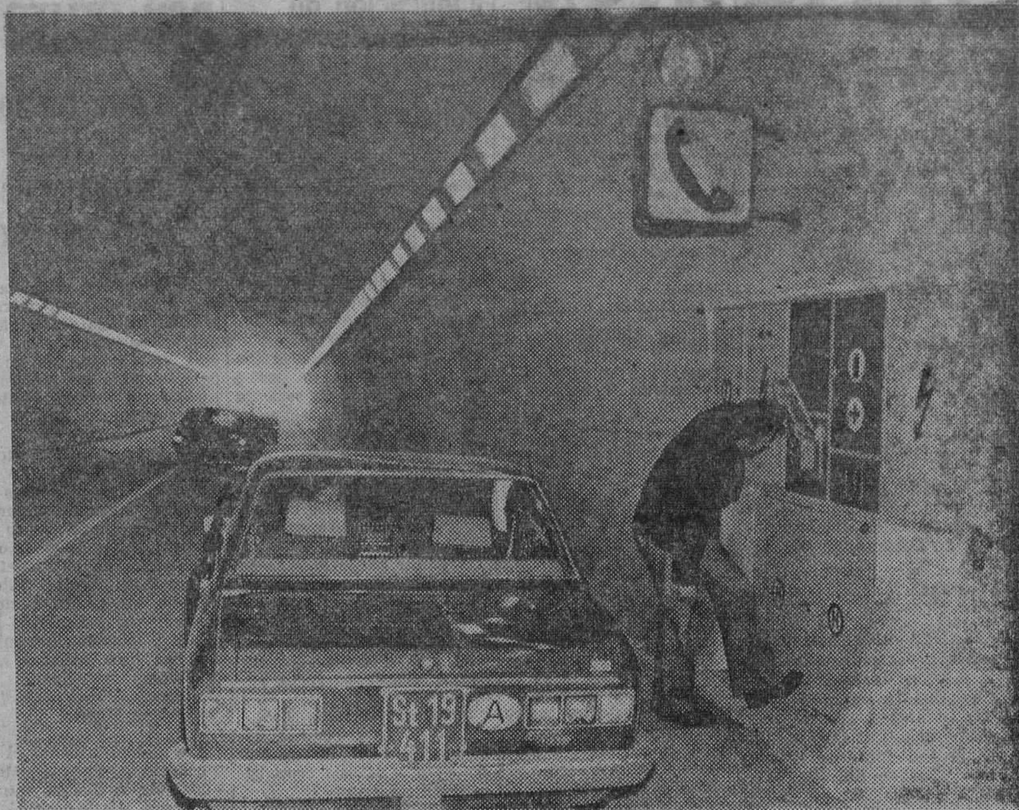
Todo conductor con problemas en el túnel del «Wolfsberg», de 750 metros de longitud, puede contar con el más rápido auxilio. La «Siemens» austríaca ha instalado un modernísimo sistema de seguridad en el tramo ya abierto al tráfico de la autopista que enlazará Salzburgo con Carintia. Cada 212 metros se han montado puestos de llamada de emergencia, así como extintores y botiquín. Basta apretar un botón para llamar al médico, a la Policía de tráfico, al mecánico o a los bomberos. — (Foto FIEL).
