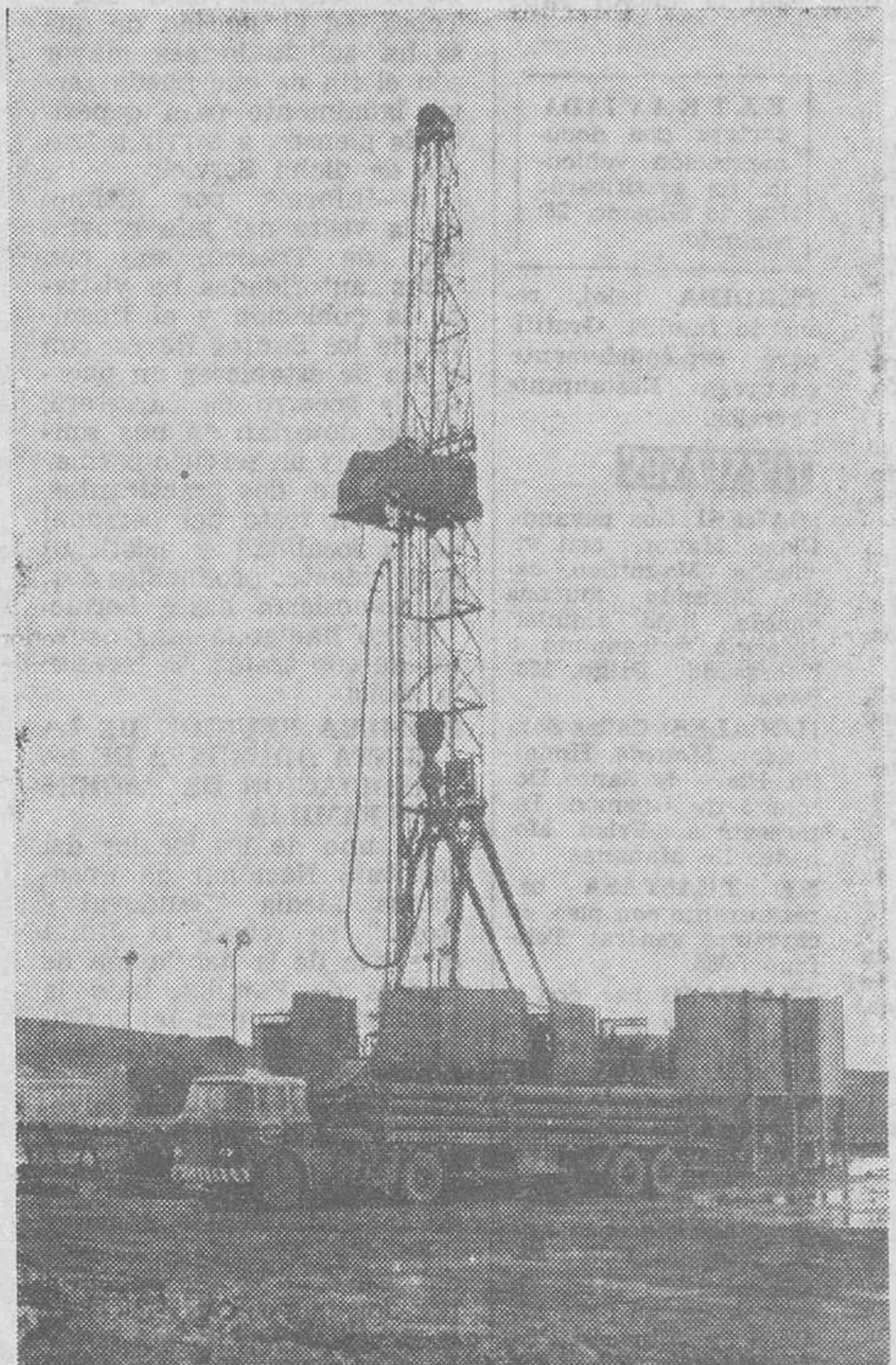
Los motores del tren de sondeo en el «Ayoluengo 24» se oyen en Sargentos de la Lora, pues sólo dista medio kilómetro el nuevo pozo que perfora «Sonpetrol». He aquí una vista de los equipos de prospección en esa otra cuadrícula. — (Foto Fedé).
