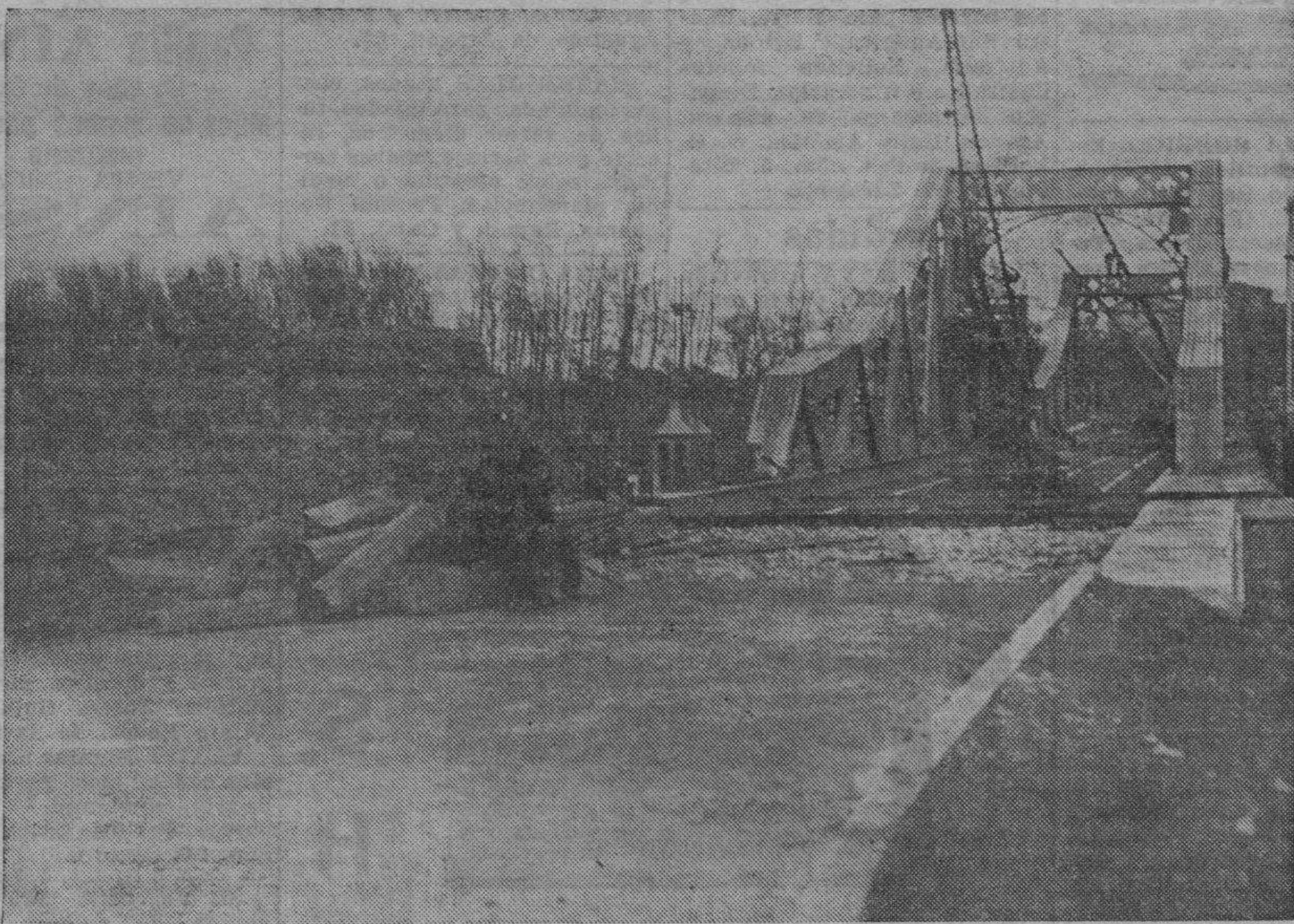
El puente en construcción sobre el río Gállego, inmediato al clásico puente colgante, al cual ha de sustituir muy en breve.
