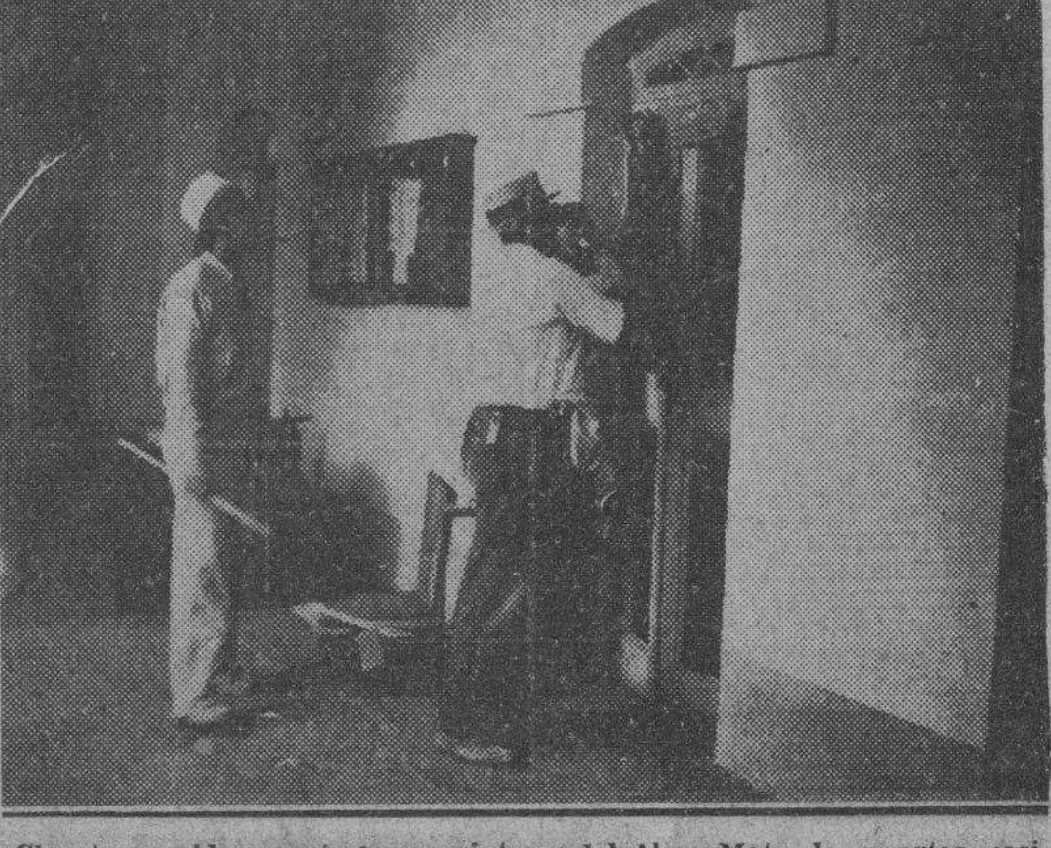
Carpinteros ruidosamente los carpinteros del Alma Mater las puertas, casi destruyéndolas, del local del Ala Izquierda Estudiantil, cumpliendo el acuerdo de clausura del Consejo Universitario
