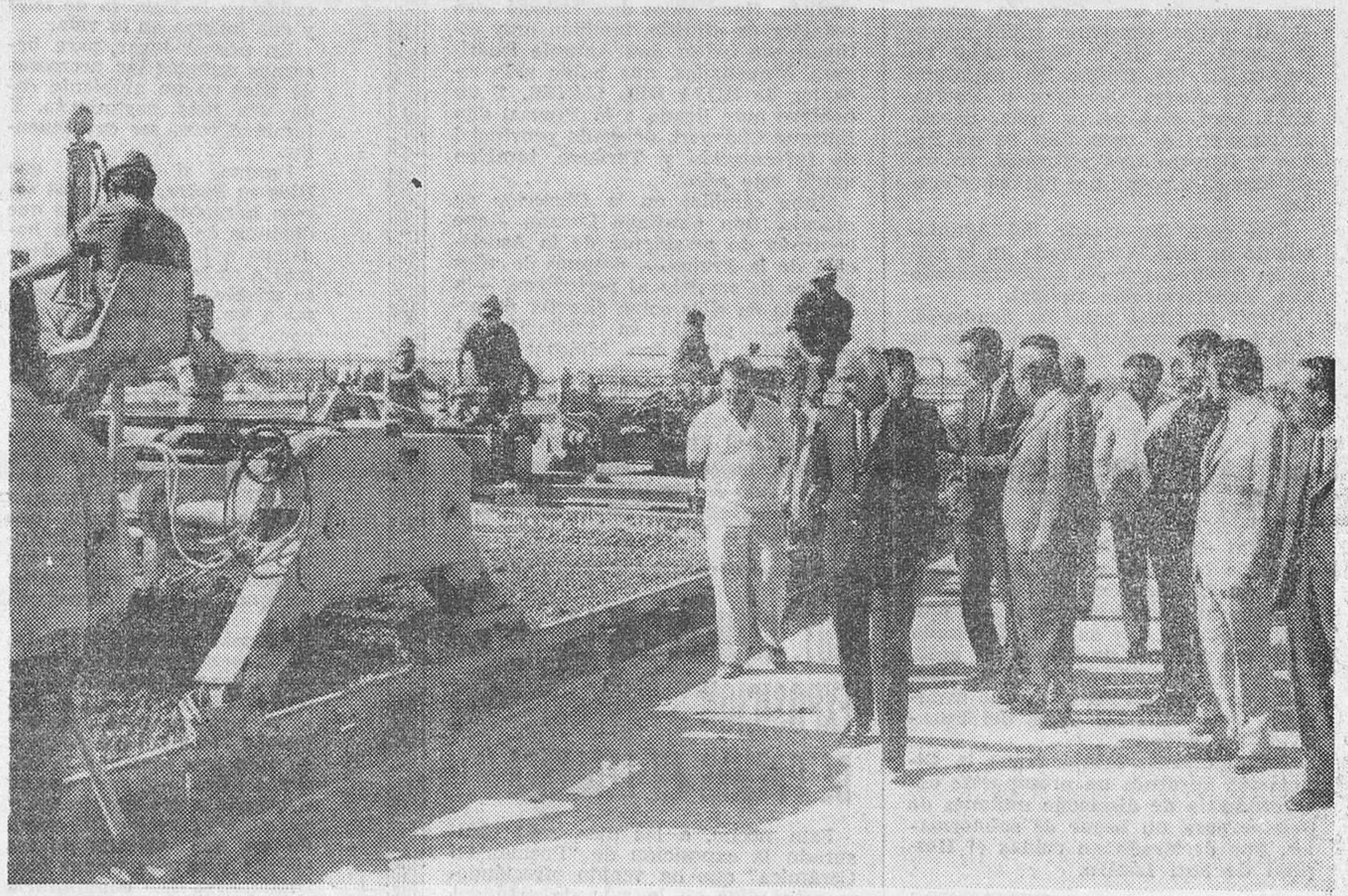
Las obras del aeropuerto están muy avanzadas, hasta el punto de que se espera que terminen en breve plazo. En la presente fotografía aparece el gobernador civil, señor Leiva Rey, en una de sus visitas de inspección a los trabajos
