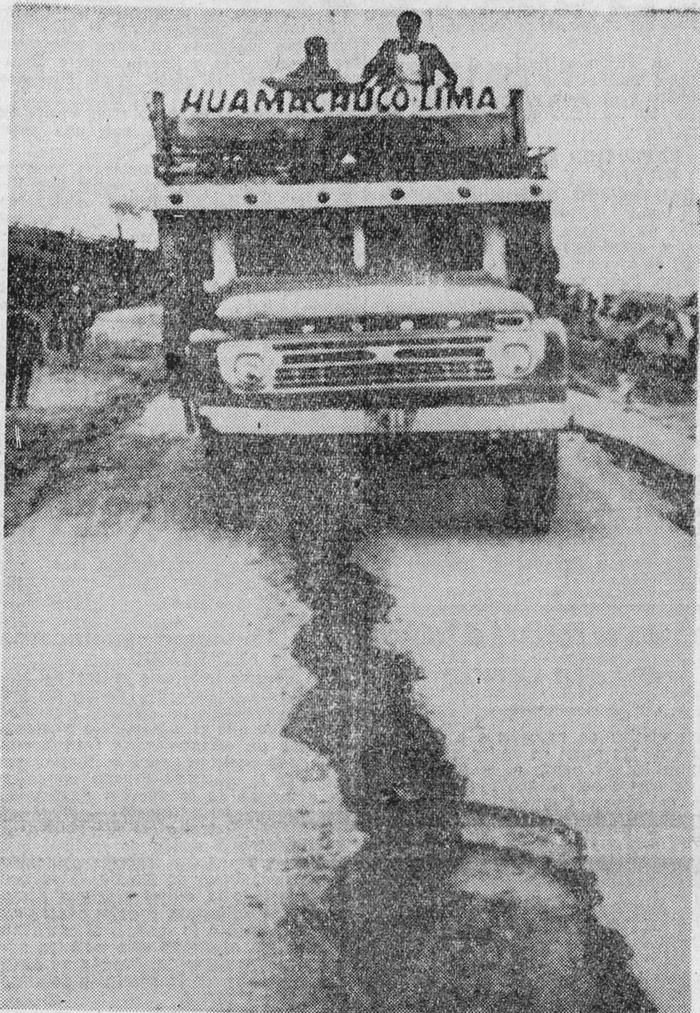
El camión avanza cauteloso através de la agrietada autopista, dañada por el terremoto que azotó Perú hace días. La escena está tomada en la salida de Chimbote. Una gran faja costera de seiscientas millas fue devastada por el catástrofo
