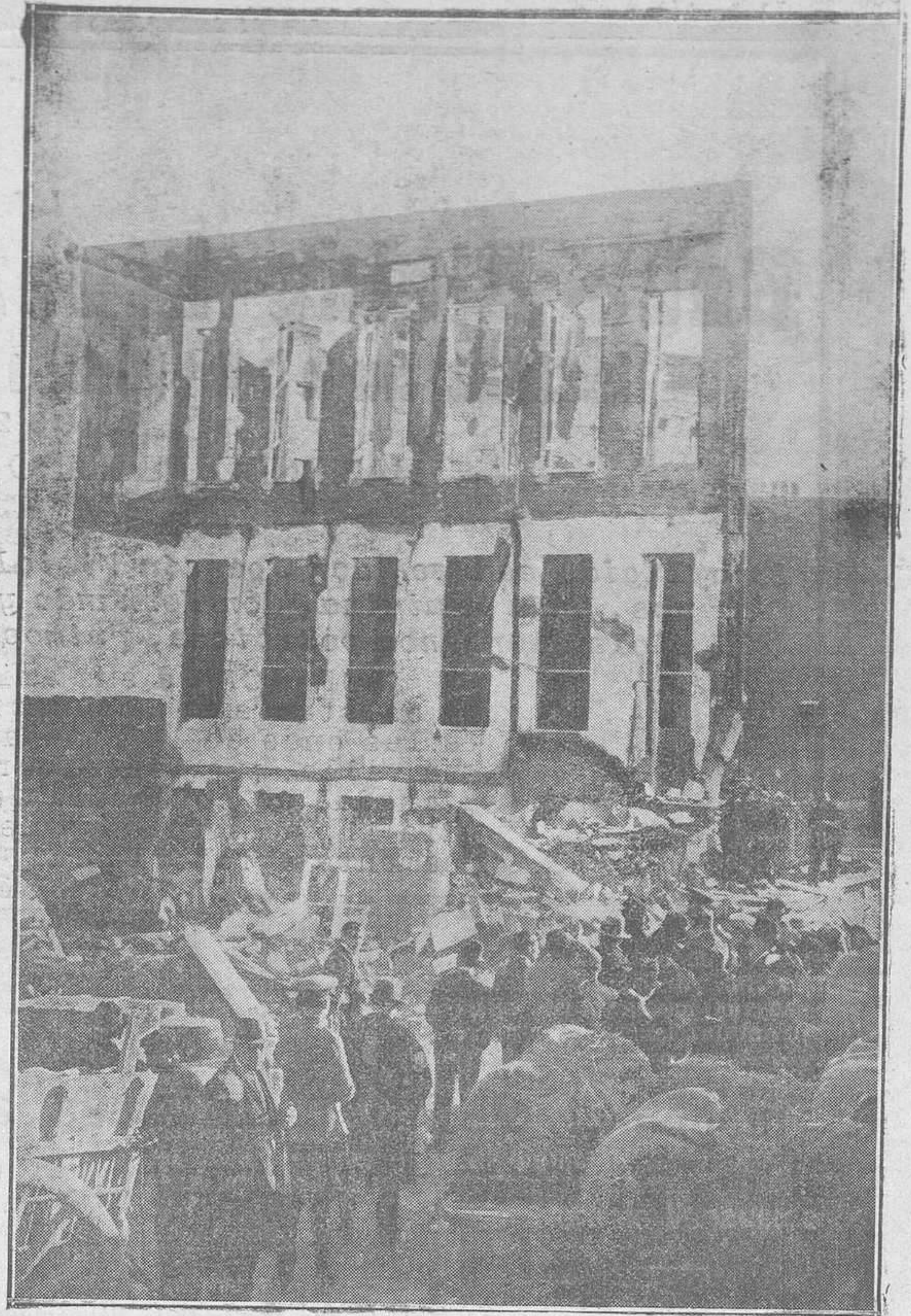
MADRID: DE LA TERRIBLE CATASTROFE OCURRIDA EN LA FABRICA "FLORALIA".--El público viendo los efectos del hundimiento.
