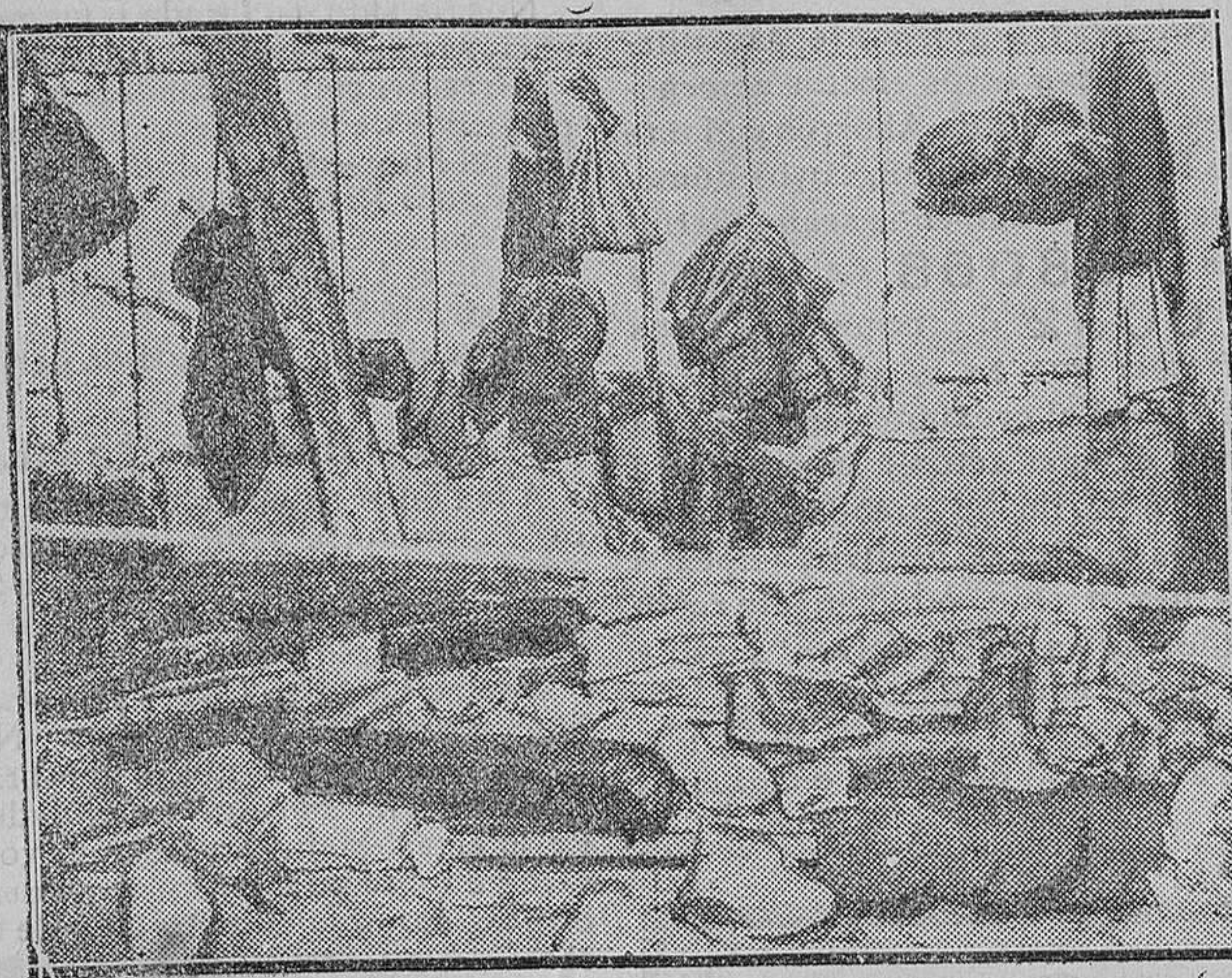
MADRID.—Hundimiento en la Posada de la Merced en la Cava Baja.—Estado en que quedó la habitación en la que dormían varios huéspedes, después del hundimiento
