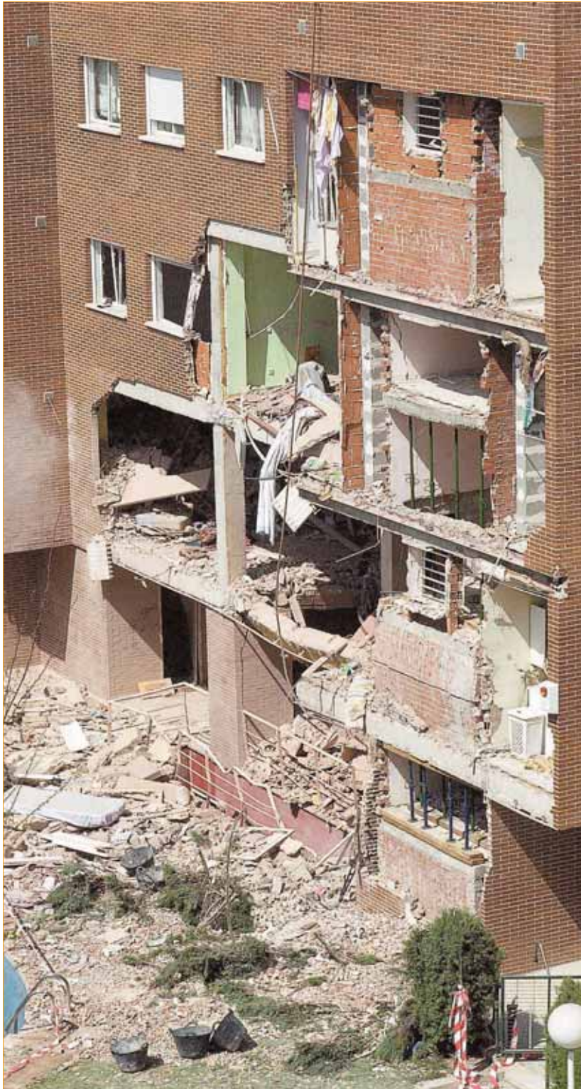
Estado en el que quedó el edificio de Leganés donde se inmolaron siete islamistas. La explosión causó la muerte del geo Javier Torronteras. /EFE
