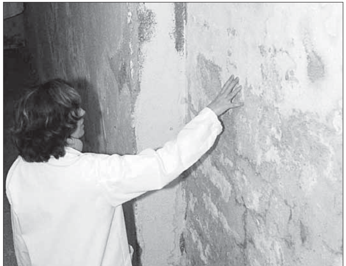
La humedad penetra por paredes enteras y atraviesa varios pisos
