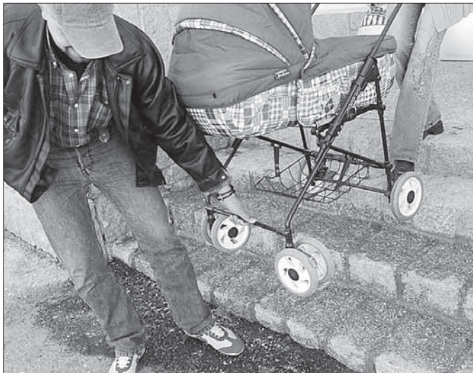
Unos escalones con las baldosas desprendidas dan paso al centro de salud
