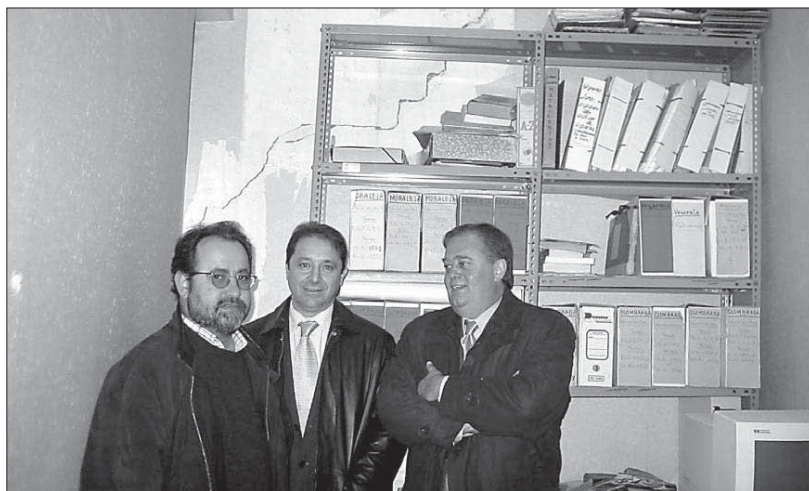
Imagen de la visita al Ayuntamiento donde se aprecian las grietas existentes
