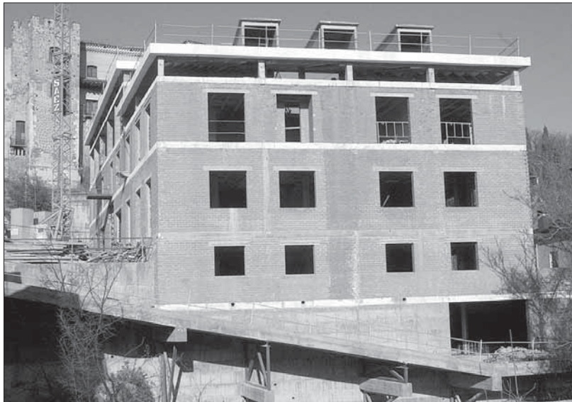
La Junta alertó que las obras del edificio no se ajustan al proyecto aprobado en su día
