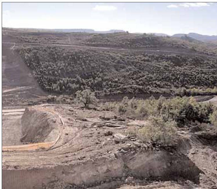
Las obras de la presa de Castrovido continúan en medio de la polémica que se ha generado
