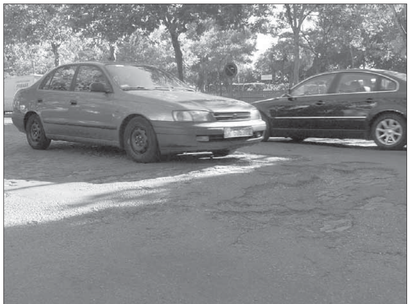
Las quejas de los vecinos se centran en el estado del firme de una vía de acceso a la ciudad
