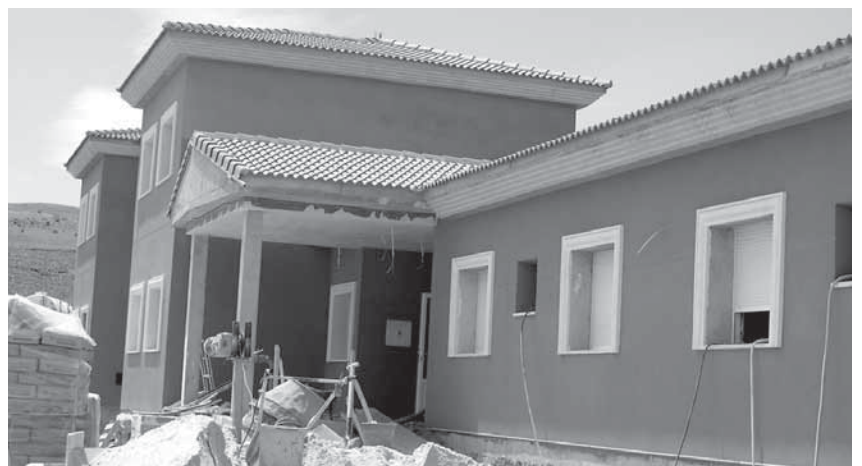
Estado actual de las obras de la futura residencia de ancianos que dará servicio a toda la comarca / EL ADELANTADO
