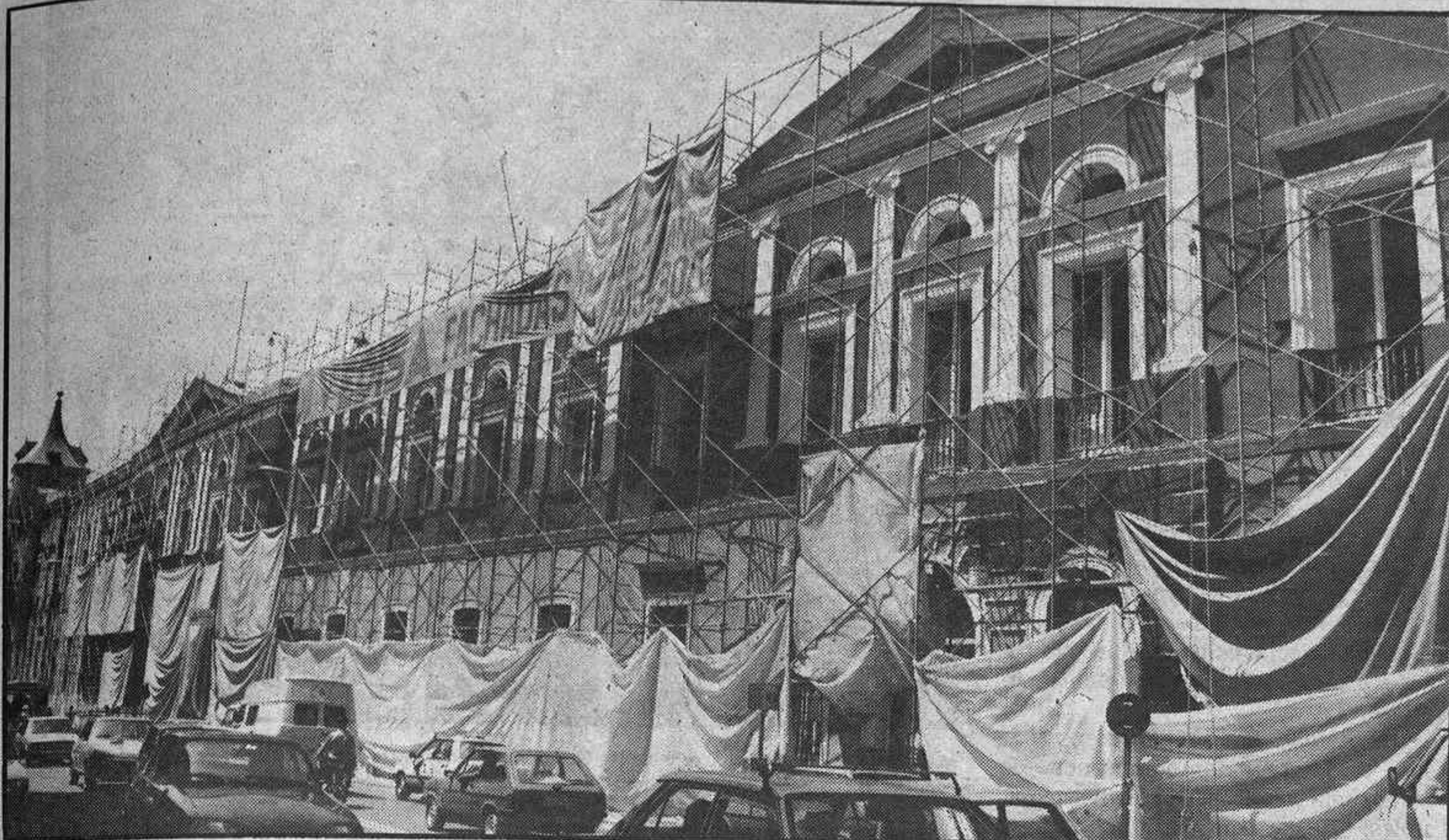
Las obras en el viejo caserón de la Universidad de San Bernardo marchan a ritmo acelerado para que los 94 parlamentarios puedan constituirse solemnemente en Asamblea
