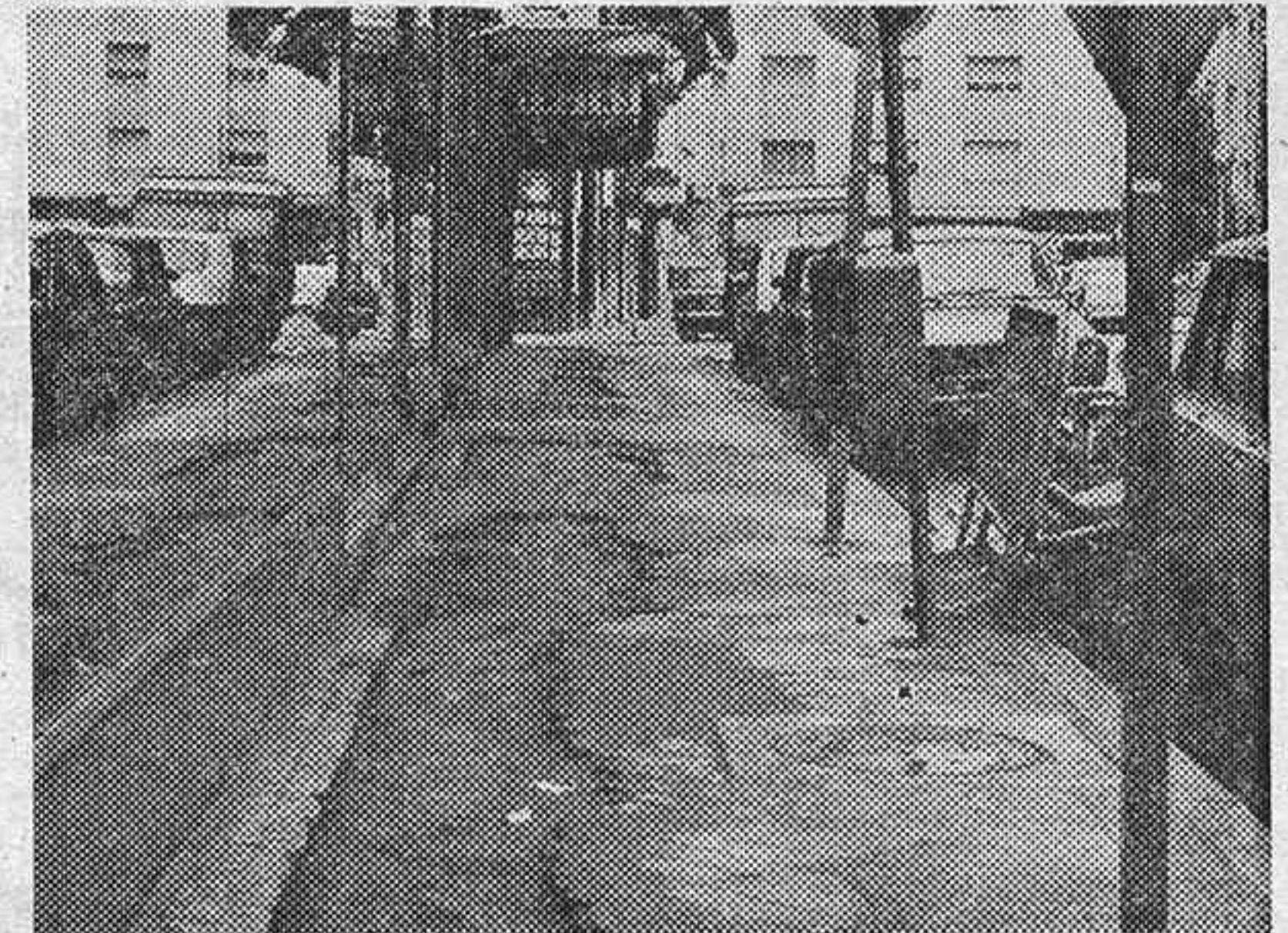
Aquí tenemos el documento gráfico en el que puede verse cómo la acera está siendo "parcheada" en un buen trecho. Estas obras se realizan normalmente en las calles más céntricas de Madrid. Por ahora... (Torremocha.)
