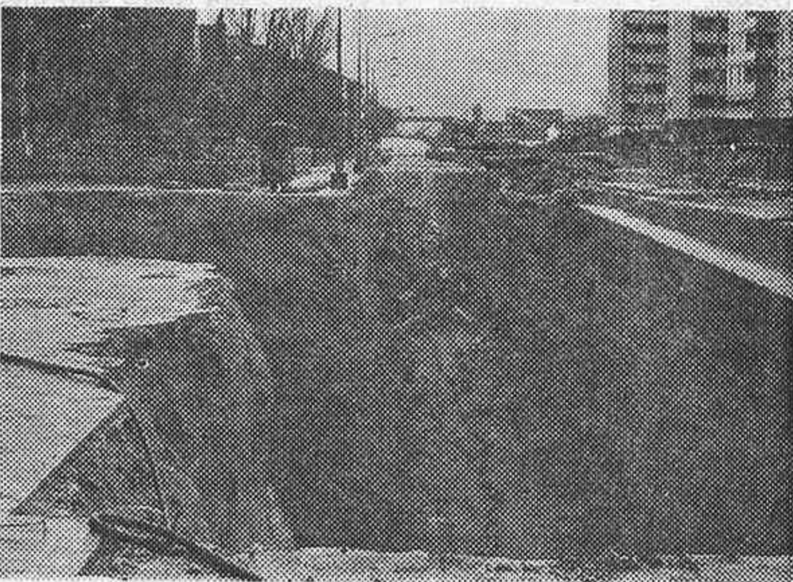
No nos extraña que los vecinos de la calle Mauricio Legendre pidan auxilio. El agujero no es para menos. (Torremocha.)
