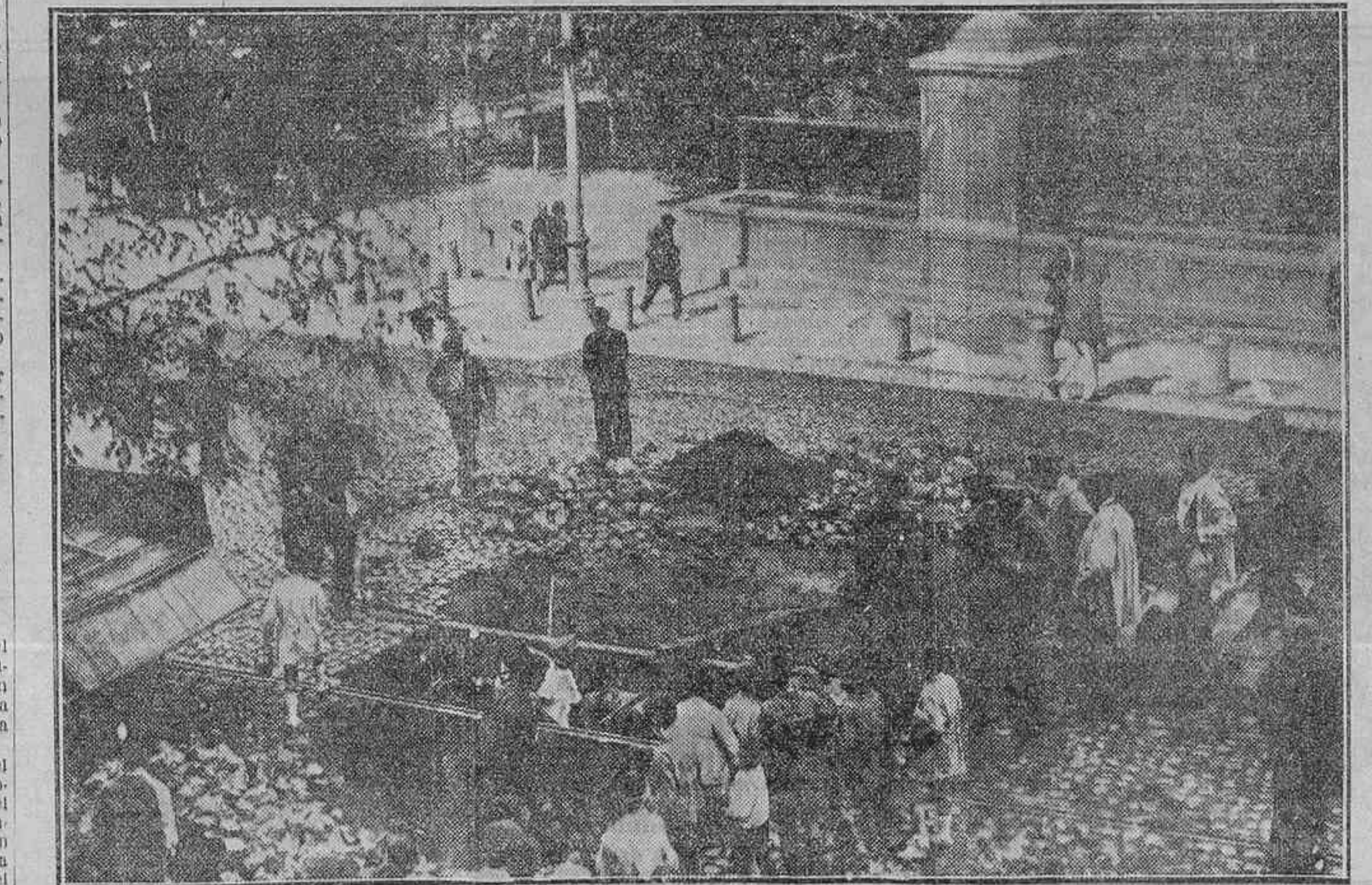
ESTADO EN QUE HA QUEDADO LA PAVIMENTACION DE LA PLAZA DE ESPAÑA DESPUES DEL HUNDIMIENTO PRODUCIDO AL PASO DE UN AUTOMOVIL. (Fotografía Alfores.)
