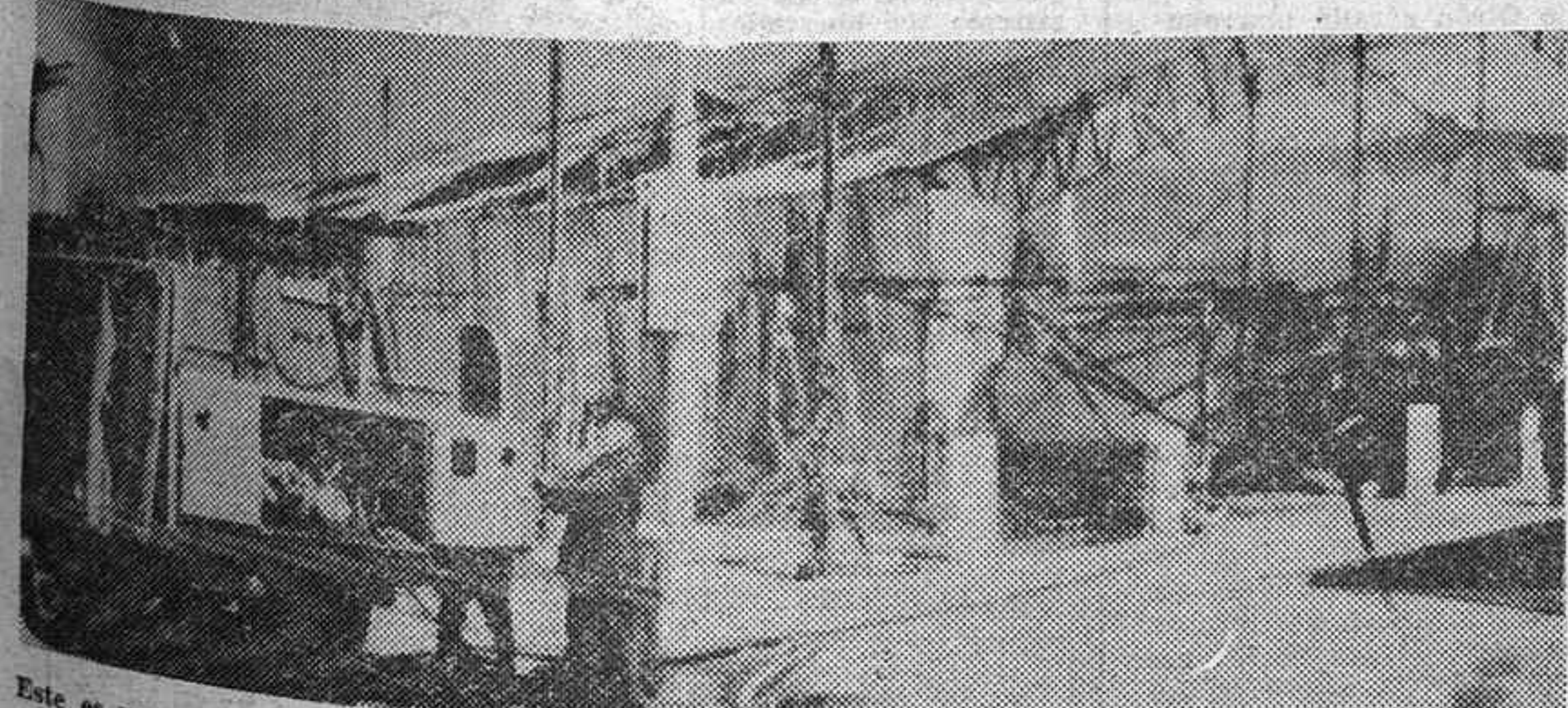
Este es un aspecto de los destrozos causados por un incendio, durante la madrugada del domingo, en el pabellón metálico de la falla del Convento de Jerusalén. (Telefoto Cifra.)
