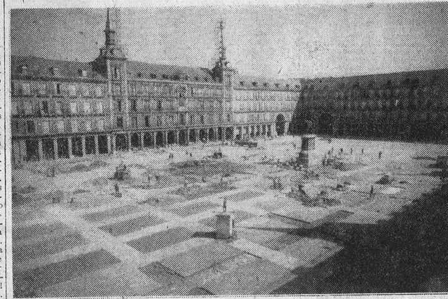
Aspecto actual de las obras de la plaza Mayor. Como se ve, aparecen en su fase final. (Foto Portillo.)
