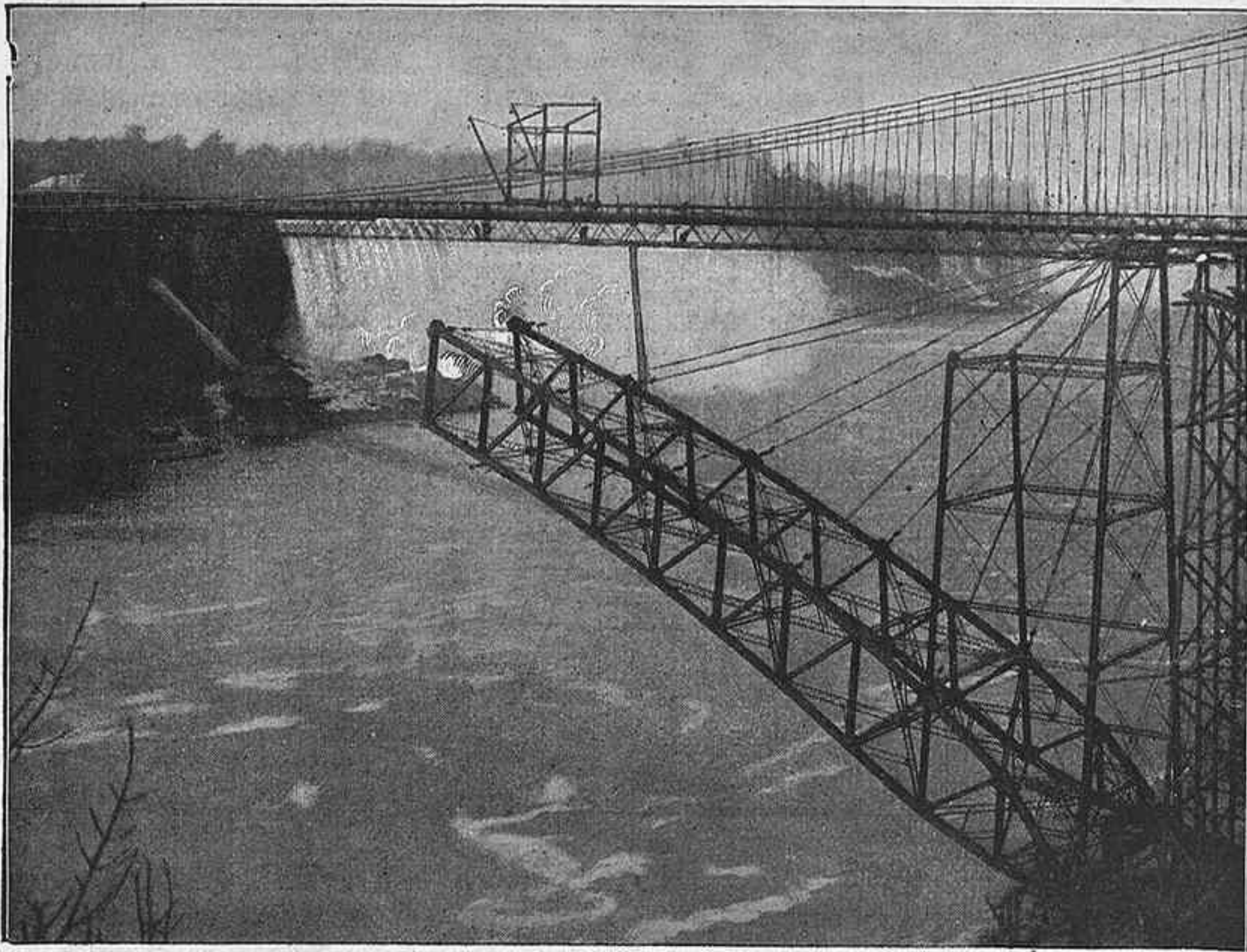
Fig. 1. - El nuevo puente sobre el Niágara. Construcción del arco debajo del antiguo puente colgante
