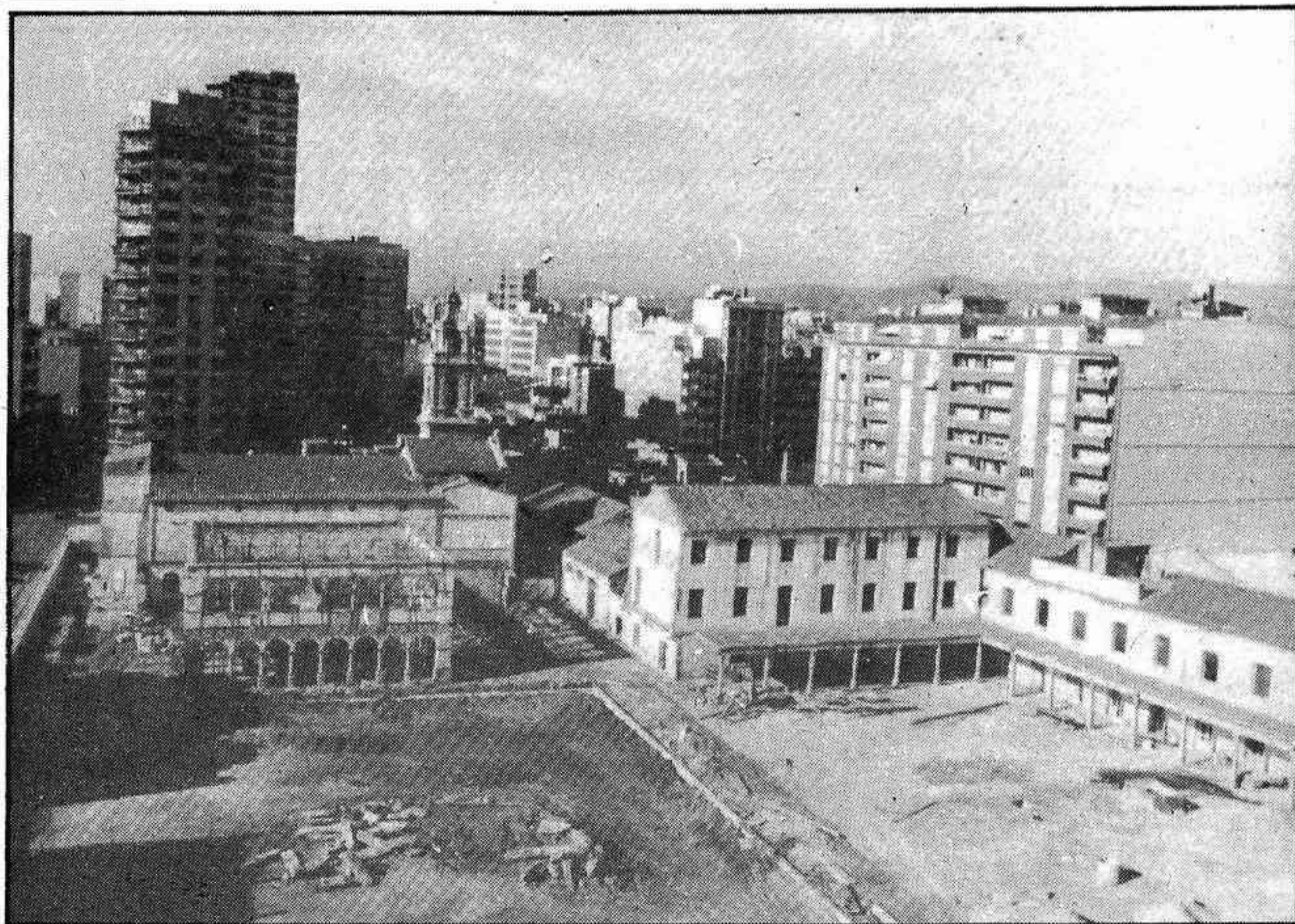
En los solares de la antigua Beneficencia, se construirá la Escuela de Artes y Oficios, dentro del Centro Cultural
