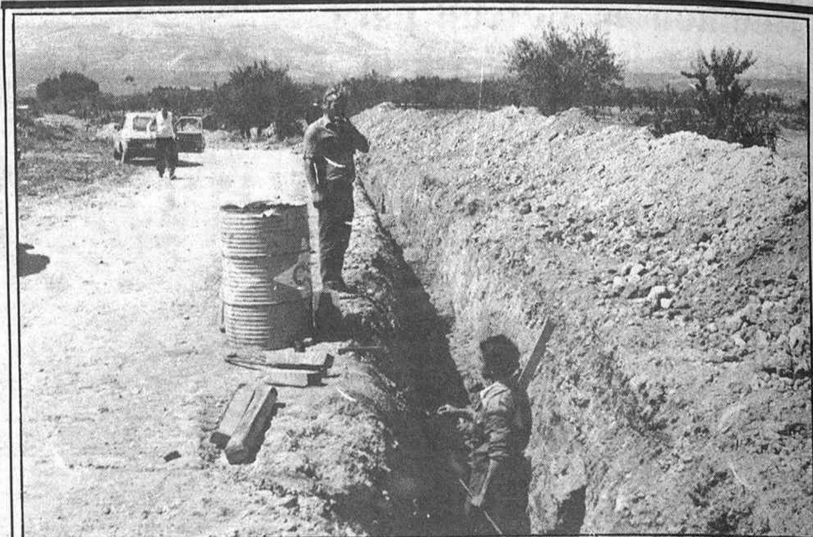
La canalización todavía no ha sido conectada a la red
