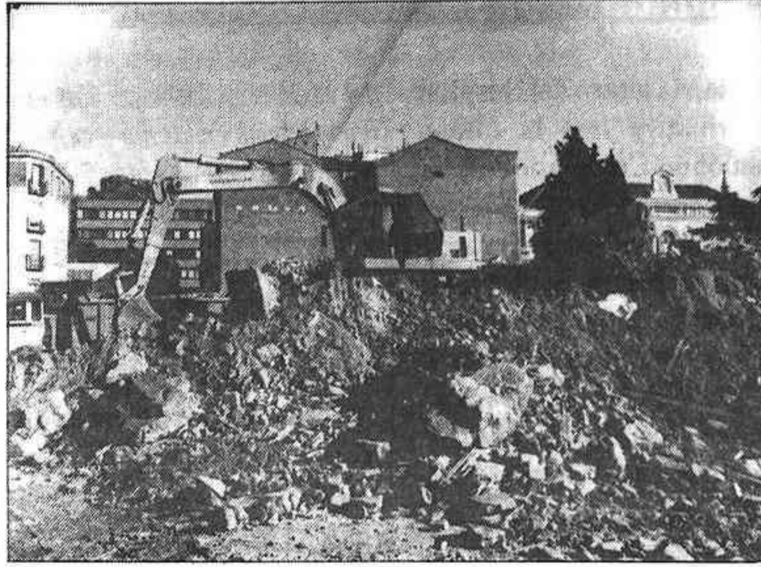
La excavadora concluyó el derribo del edificio durante la pasada semana. El Ayuntamiento levantó la orden de paralización / FOTO: VALENZUELA
