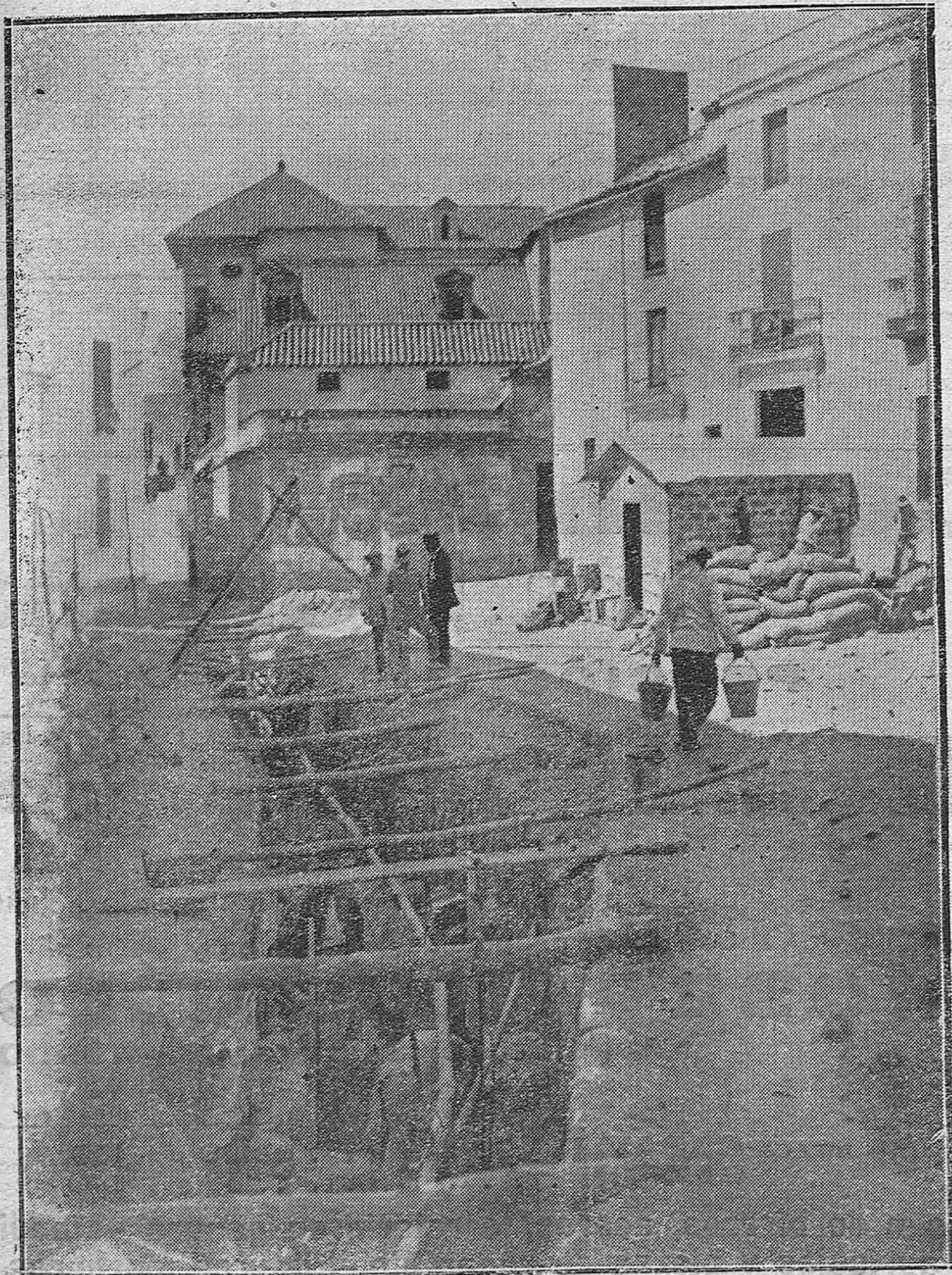
EL NUEVO ALGANTARILLADO QUE SE CONSTRUYE EN LA PLAZA DE SAN FELIPE, CUYAS OBRAS CONSTITUYEN UN SERIO PELIGRO PARA AQUELLAS PERSONAS QUE TIENEN NECESIDAD DE TRANSITAR POR DICHO LUGAR A MEDIA NOCHE A CAUSA DE LA FALTA DE ALUMBRADO.
