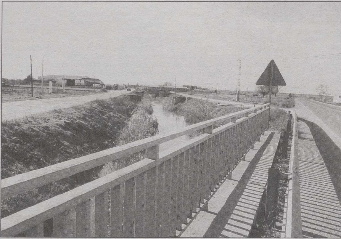
El Canal de María Cristina necesita una limpieza en su tramo cubierto.
