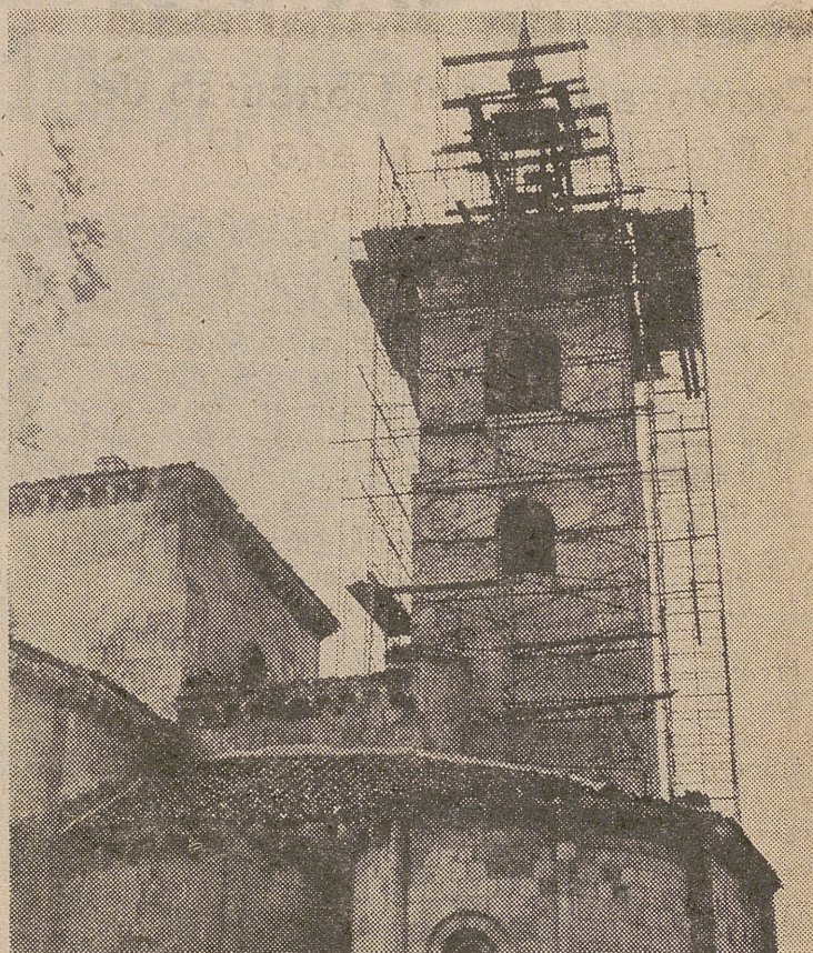
Las torres de varias iglesias segovianas vieron reemplazarse sus bellos chapiteles de pizarra denominados "montera", por otros similares, con nuevas armaduras. En la foto, proceso del montaje en la de San Millán.
