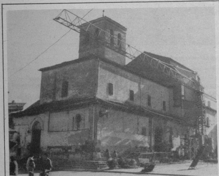
Se iniciaron las obras de restauración de la iglesia de El Salvador
