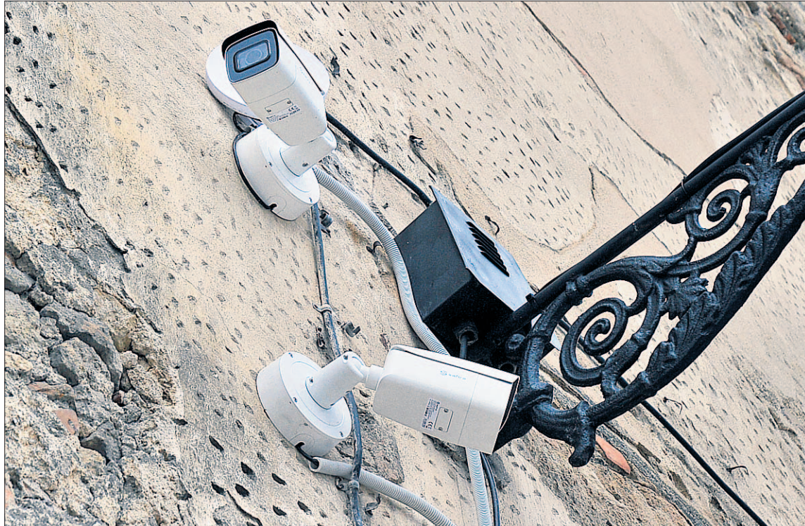
Las dos cámaras se han instalado junto a uno de los brazos de los faroles del alumbrado público. / KAMARERO
