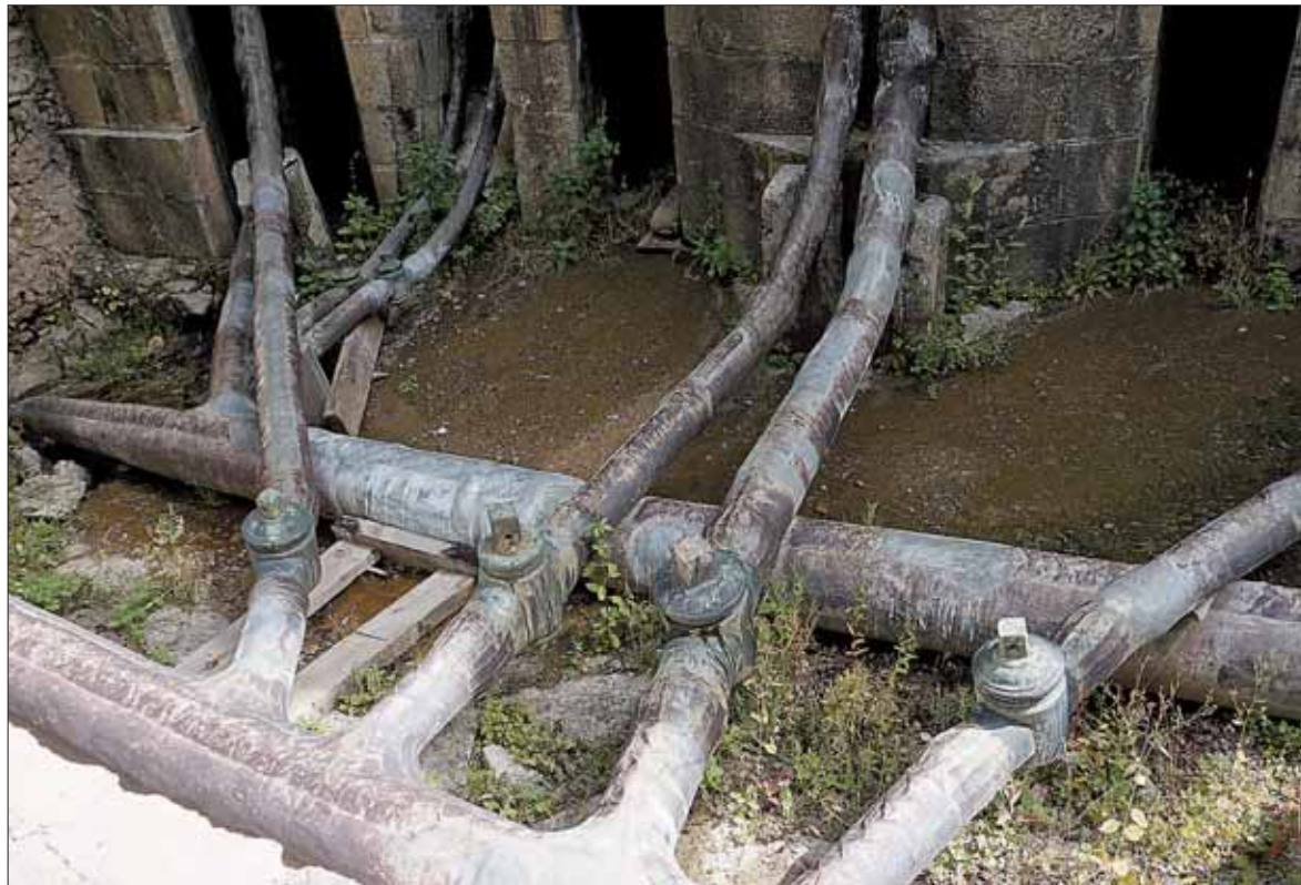
Las tuberías de 'Baño de Diana' han sufrido una de las peores averías del sistema hidráulico de las Fuentes. / L. SANZ
