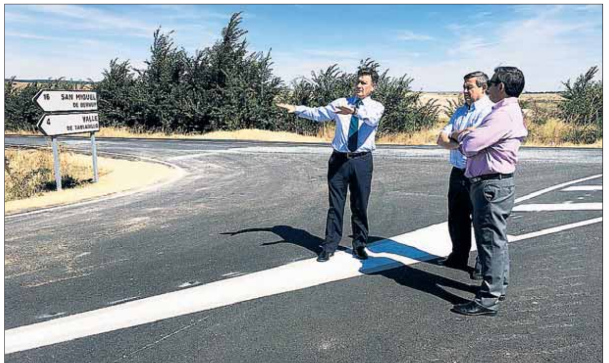
Francisco Vázquez comprobó el resultado de los trabajos hechos en la carretera SG-V2415. /EL ADELANTADO
