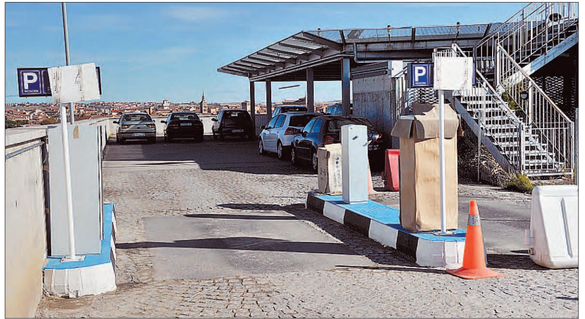
Las máquinas para controlar el acceso al aparcamiento del Hospital General están instaladas sin uso desde el verano.
