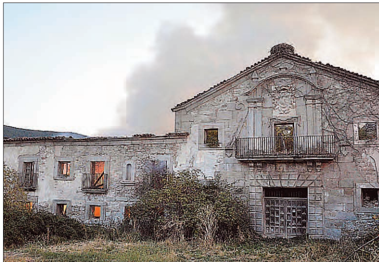
El edificio de los Marqueses de Perales se encuentra prácticamente en ruinas.
