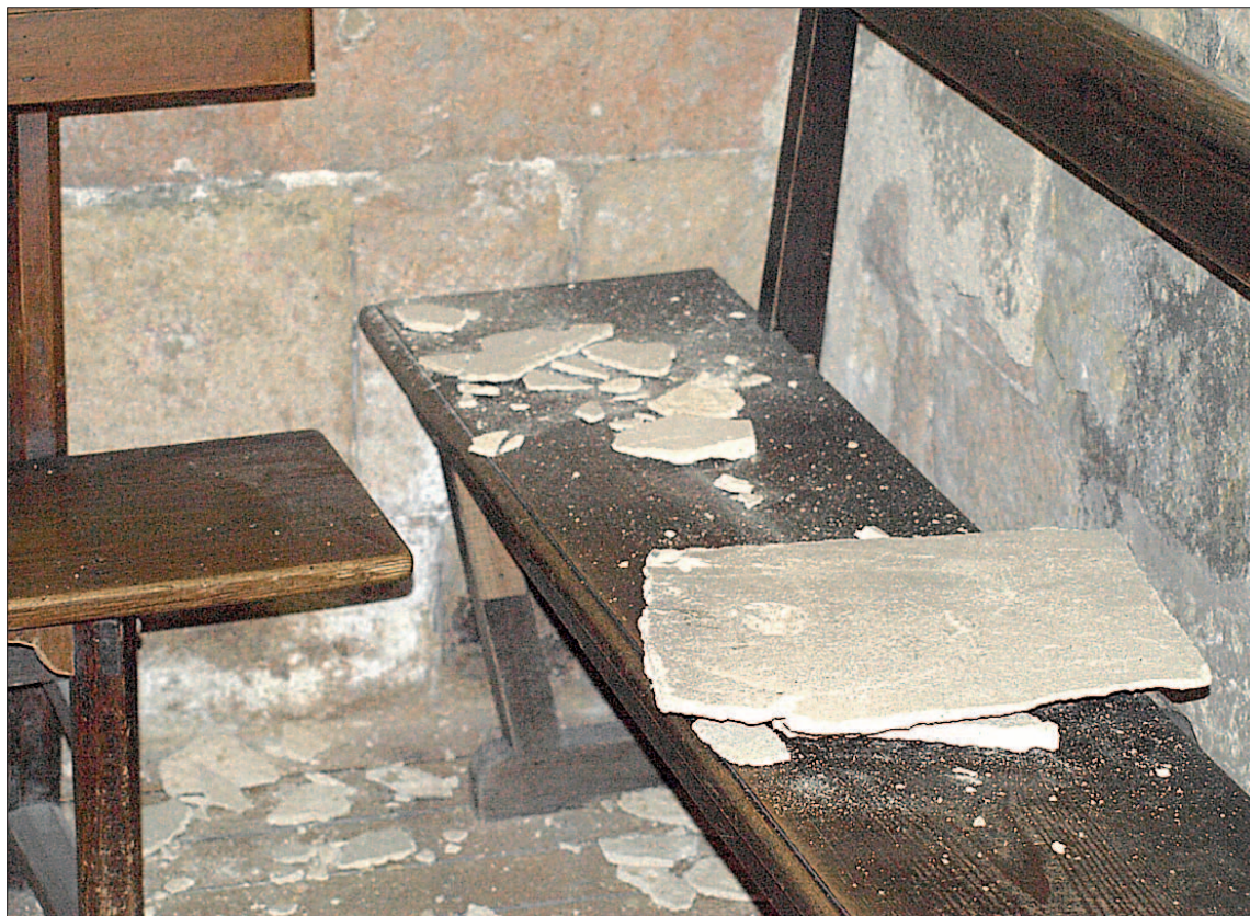
Placas de los muros que han caído sobre los bancos y suelo de la iglesia de la Trinidad./EL ADELANTADO
