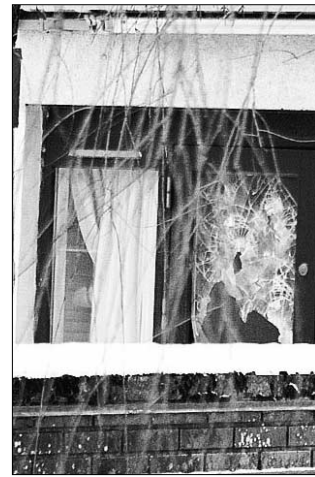
La ventana rota de la casa.
