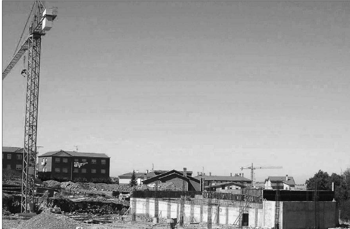
Imagen de archivo de las obras de construcción del pabellón deportivo de Palazuelos de Eresma. / EL ADELANTADO
