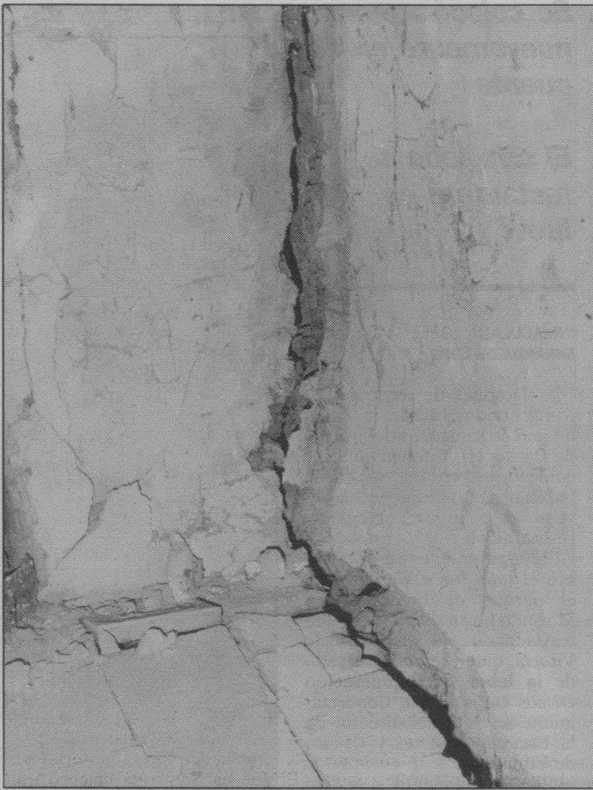
Algunas de las casas colgantes constituyen un peligro muy alto.
