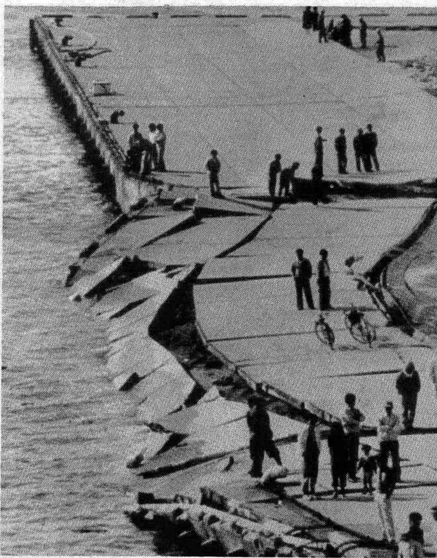
Estado en que quedó el embarcadero de Akita tras el terremoto.
