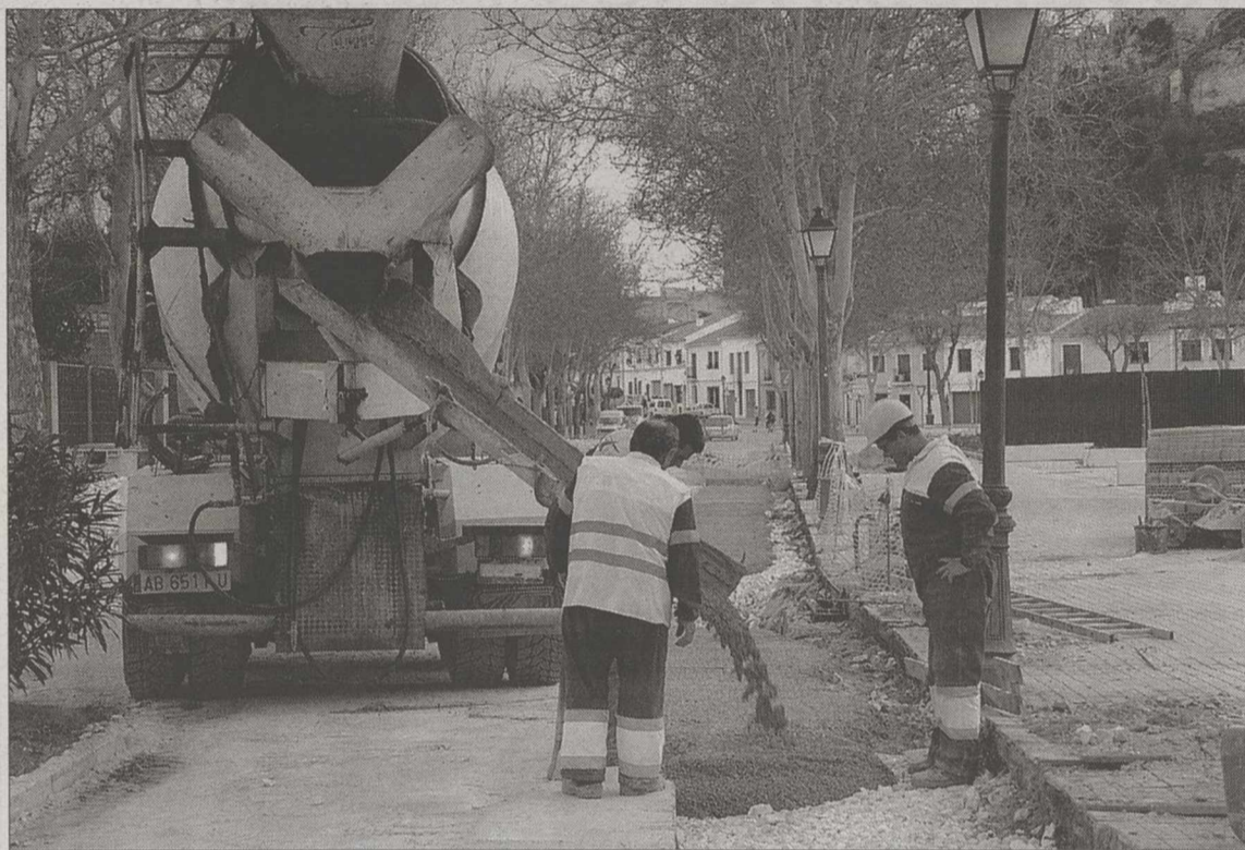
Aspecto de unas recientes obras de saneamiento realizadas en la red de aguas potables de la ciudad. / LUIS BONETE
