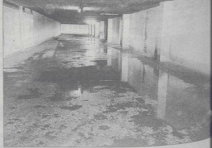
Las filtraciones se vienen produciendo desde hace años.
