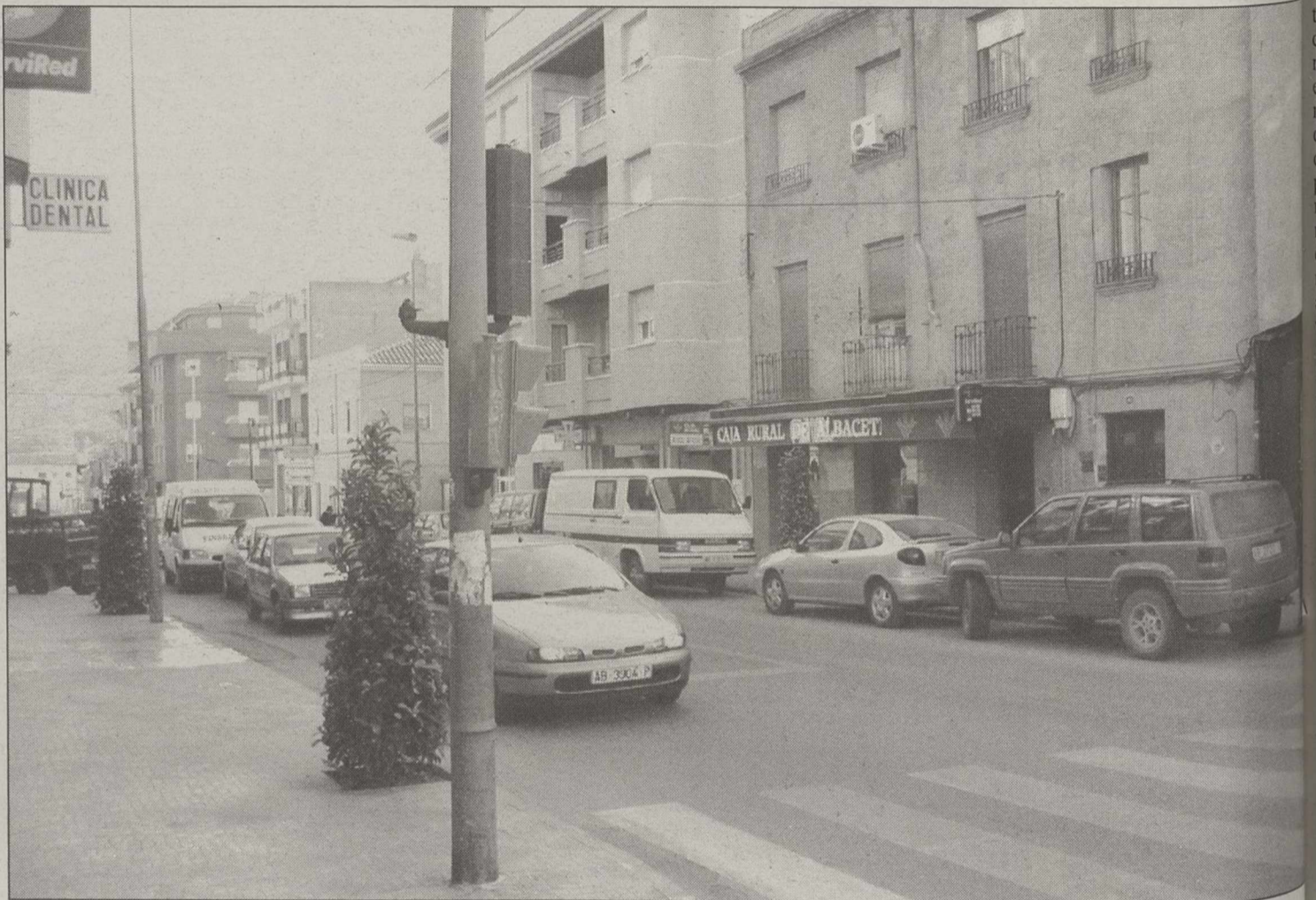
La Avenida Melchor de Macanaz tiene que ser asfaltada de nuevo.
