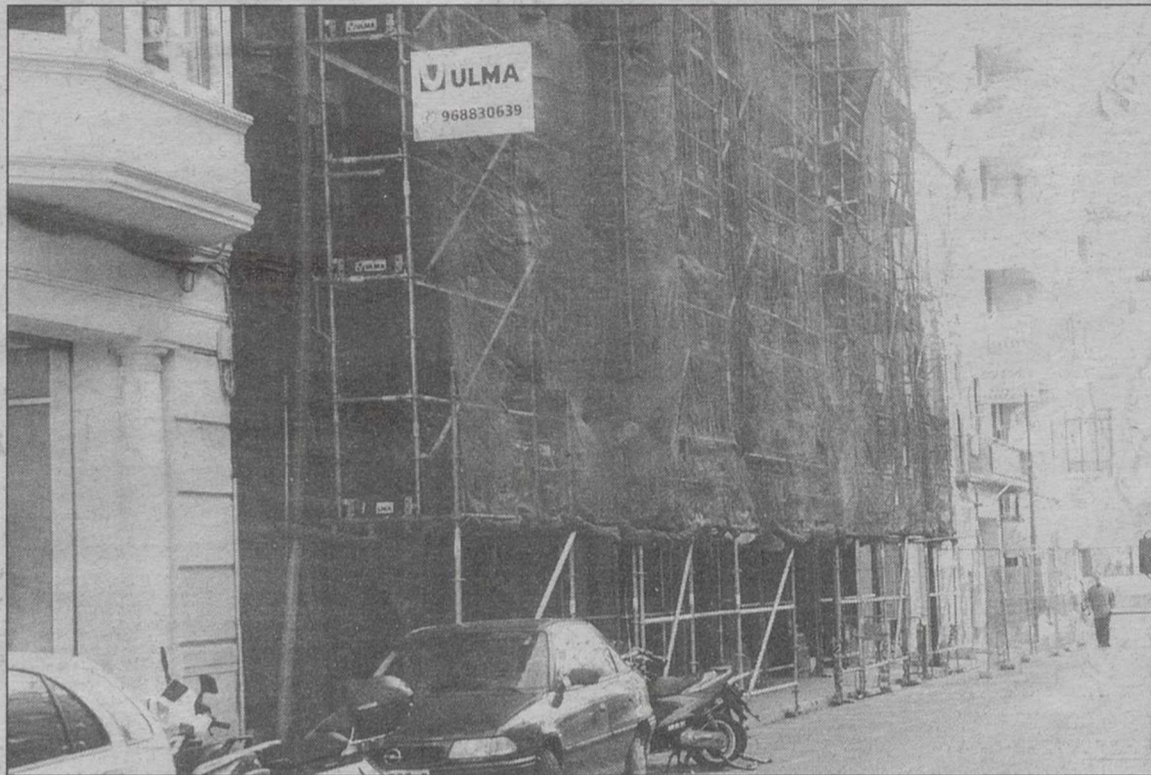
Las obras de mejora en el Pasaje de Lodares podrían estar terminadas antes de Feria. J.M.
