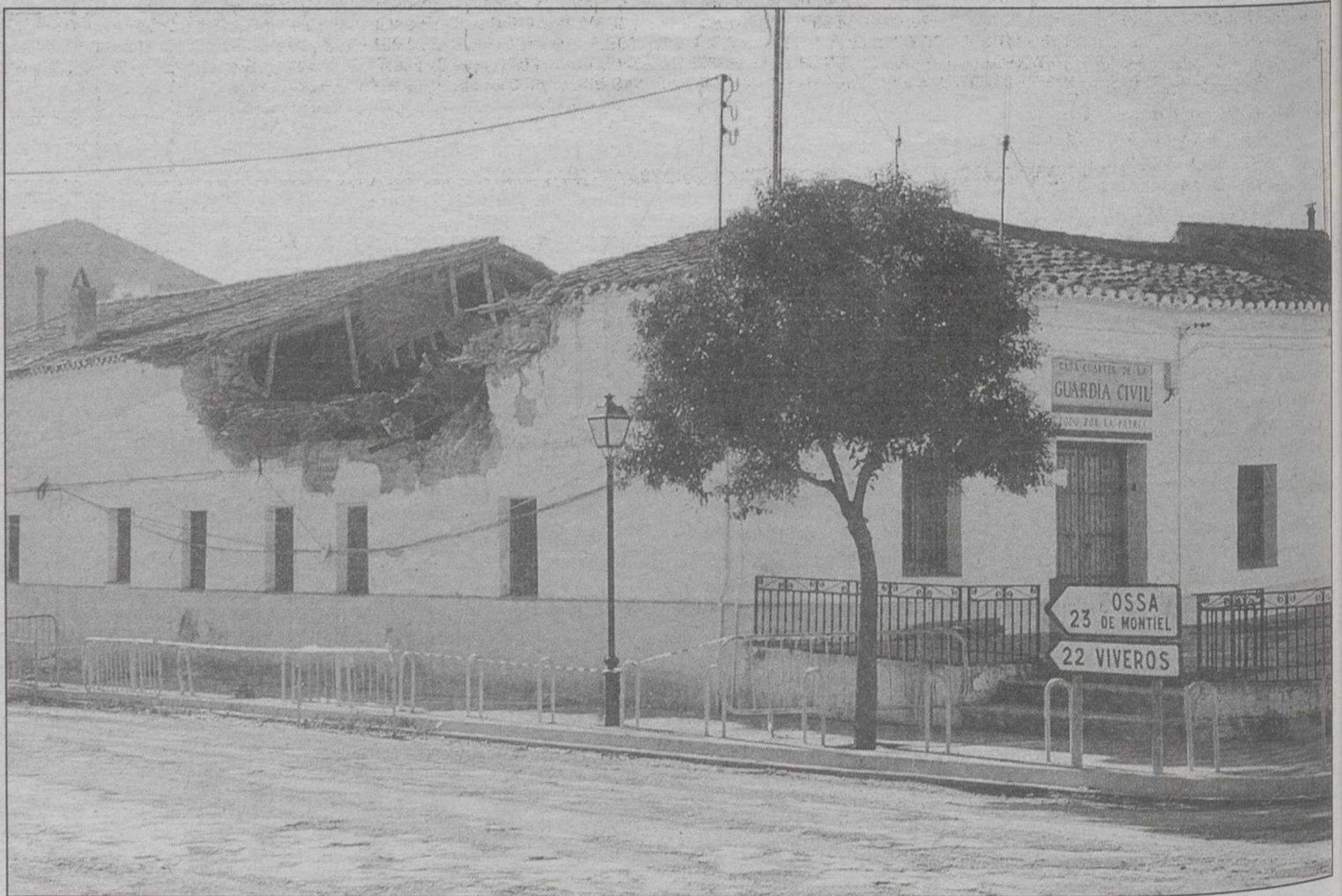
El derrumbe ha afectado principalmente a la vivienda de una familia.
