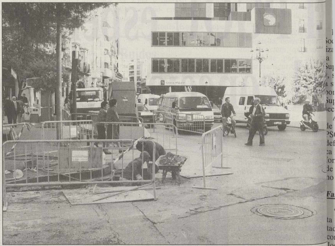
Albacete Sistemas de Cable ya ha iniciado el cableado aprovechando las zanjas abiertas por diversos motivos.
