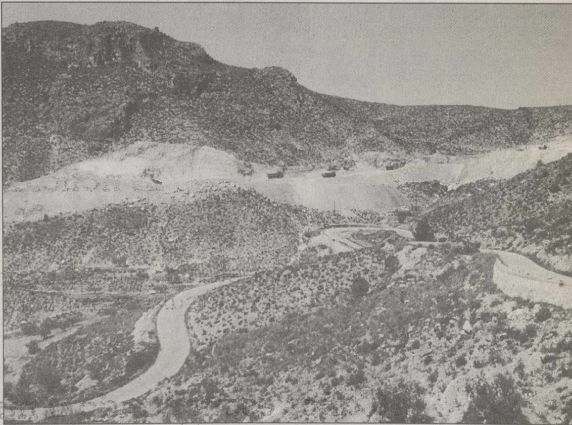
El daño ecológico que están produciendo las obras es muy considerable, al tratarse de una zona de sierra.
