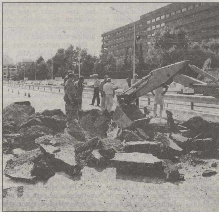
La avería obligó a levantar un tramo de Circunvalación.
