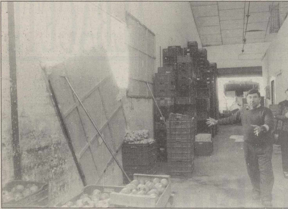
Estado que presenta el derrumbe parcial en un muro de la Lonja.
