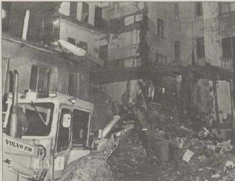
El desplome comenzó en el tejado y arrastró a todos los pisos inferiores.
